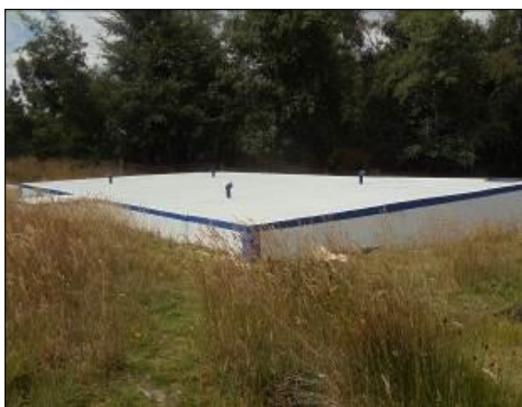
Tanque de almacenamiento, PTAP Vivero.
