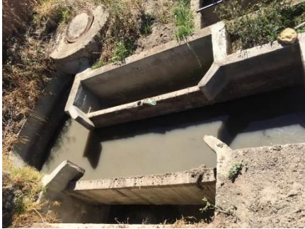
Entrada de caudal de agua residual
