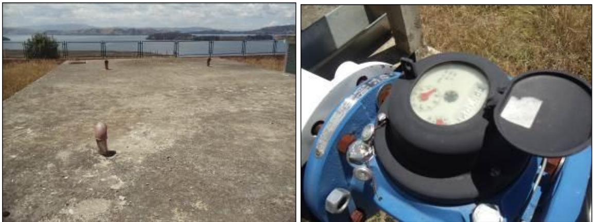
Fuente: Tanque de almacenamiento Macromedidor PTAP Santuario
