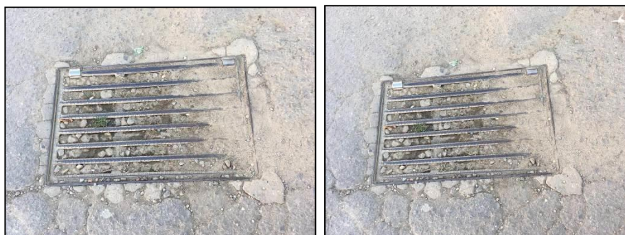
sumideros de aguas lluvias.
