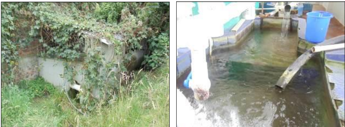
Fuente: Captación canaleta Parshall Páramo Nacedero el Vivero. Fuente de abastecimiento
