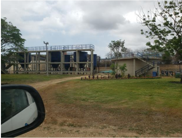
Foto 13. Planta de tratamiento de lixiviados.
