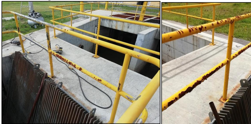
Fotografía 5-6. Estructuras oxidadas de la EBAR
