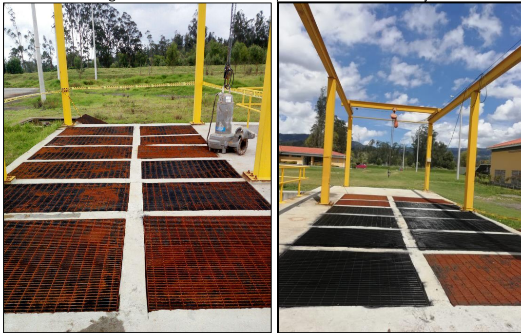
Fotografía 3-4. Estado inicial y estado actual de rejillas de la EBAR
