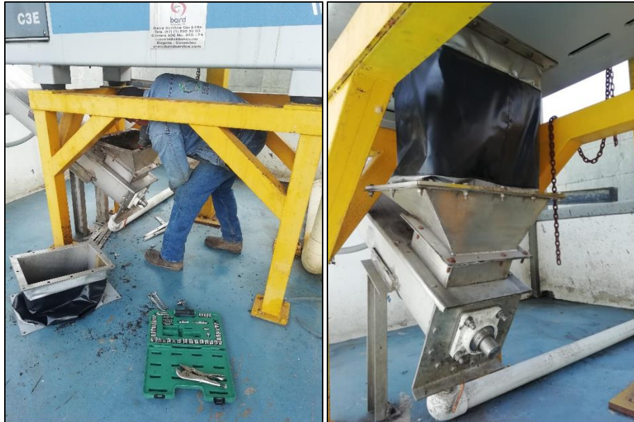
Fotografía 13-14. Estado inicial y montaje de tornillo sin fin-decanter
