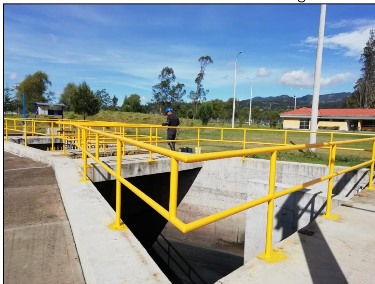
Fotografía 9. Estado final estación de bombeo de aguas residuales-PTAR
