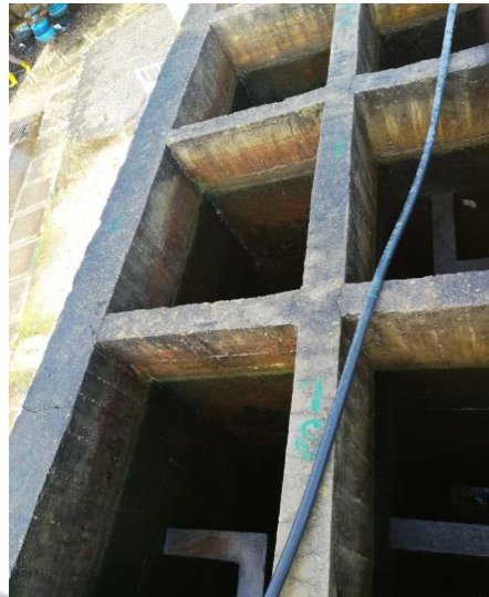
Fuente, tomada desde los tanques de floculación.
