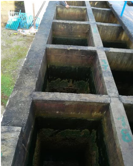
Fuente, tomada desde los tanques de floculación.
