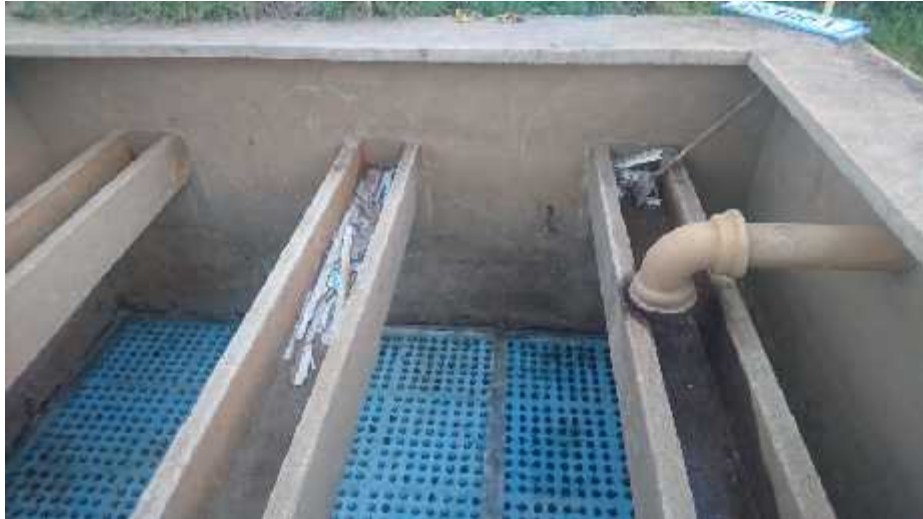
Reparacion pliegues en fibra de vidrio lamina falso fondo y cambio de boquillas.
