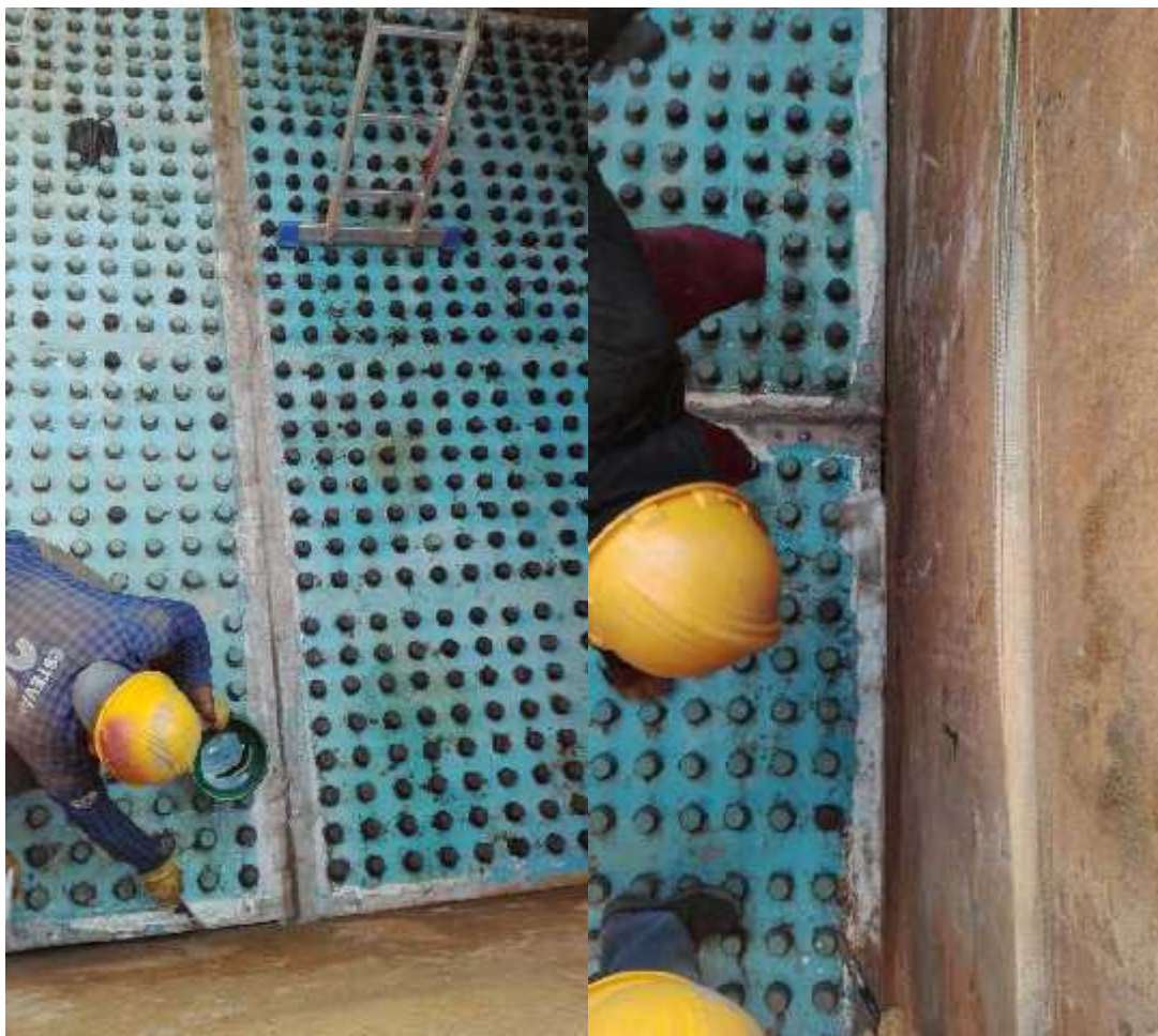
Reparacion pliegues en fibra de vidrio lamina falso fondo y cambio de boquillas.
