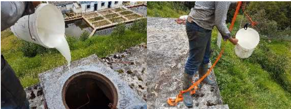
Mezcla cloro agua e inyeccion al tanque.
