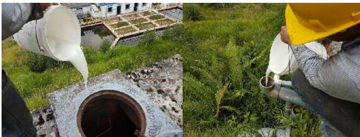
Mezcla cloro agua e inyeccion al tanque.
