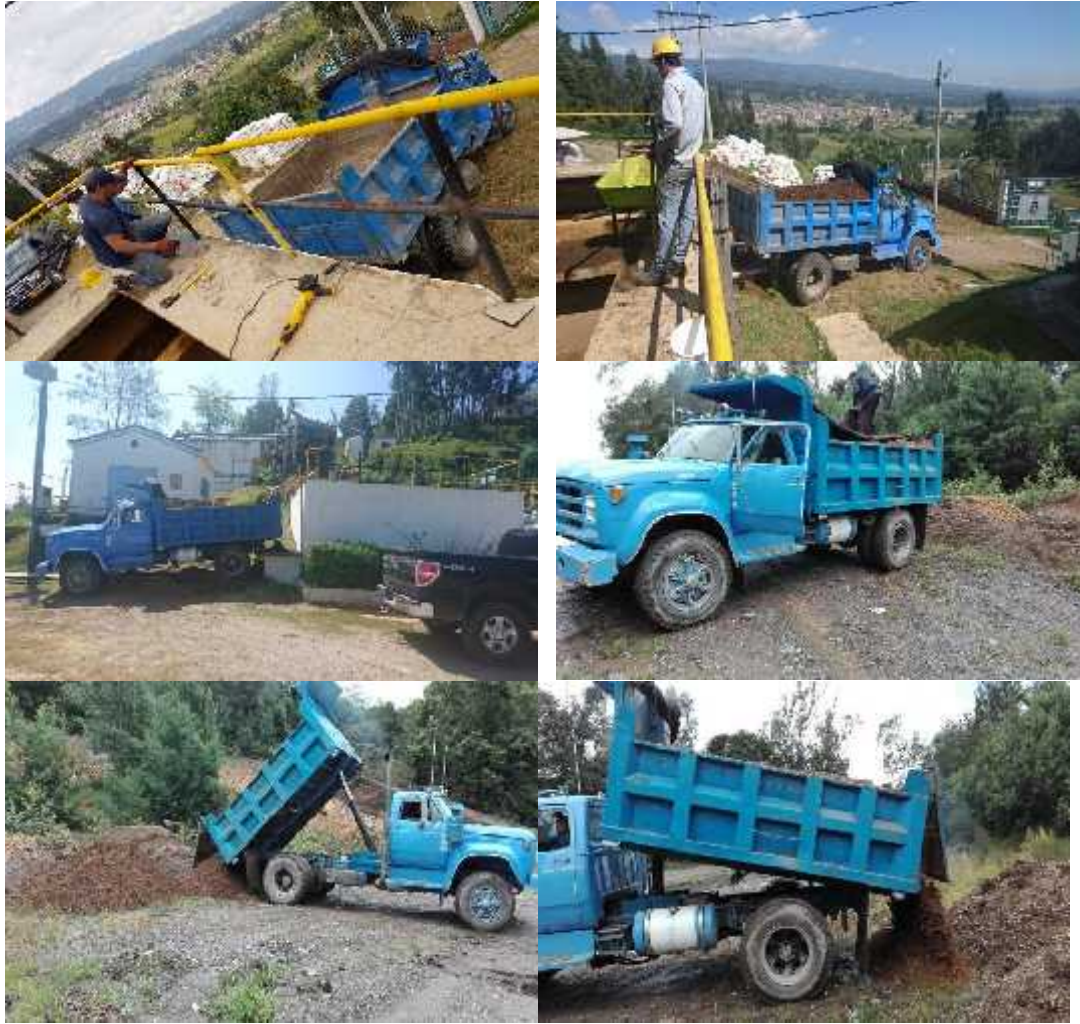
Retiro de material ya desinfectado en volqueta y disposición en el relleno sanitario
