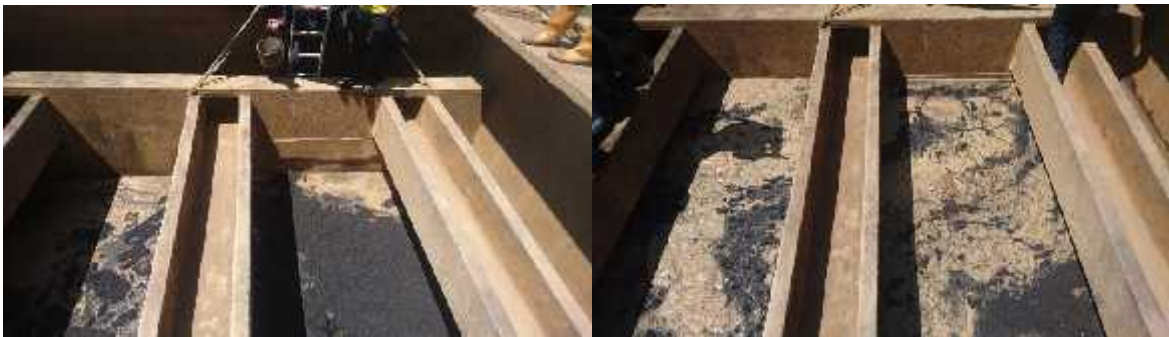
Retro lavado de filtro lecho nuevo.
