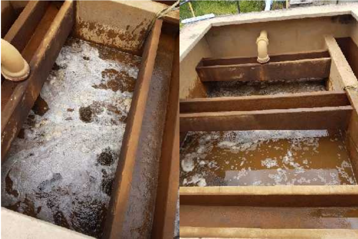
Llenado de agua en forma descendente con agua clorada para la desinfección.
