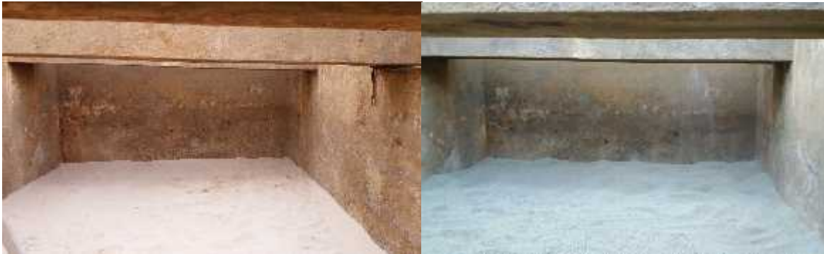
Segundo lecho de arena despues de la zeolita.
