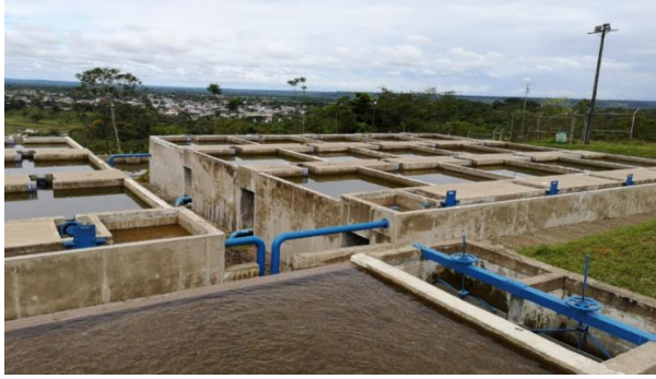
Filtros dinámicos y filtros gruesos ascendentes
