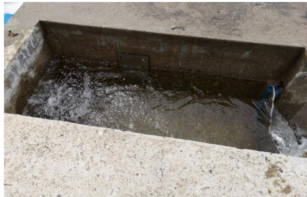
Canaletas de medición
