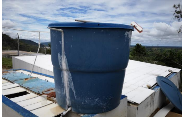
Dosificador manual de cloro
