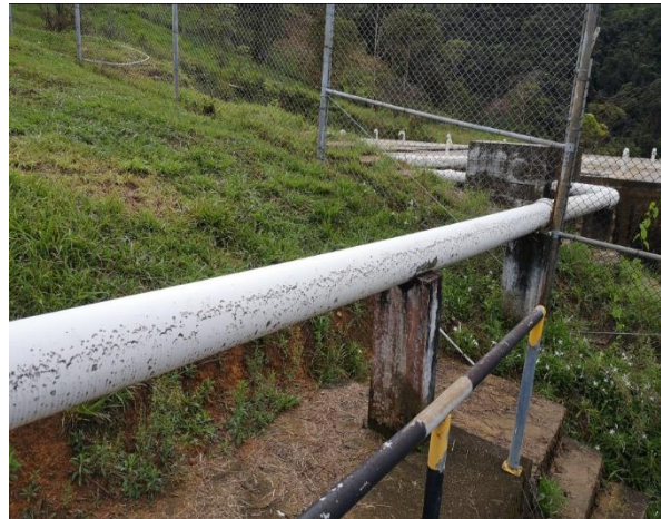
Salida a tanques
