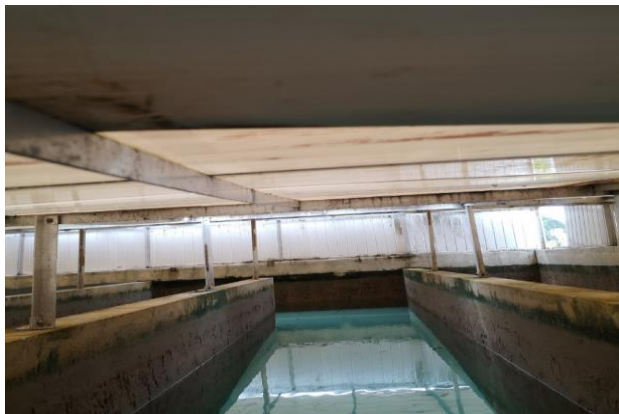
Estructura de cloración
