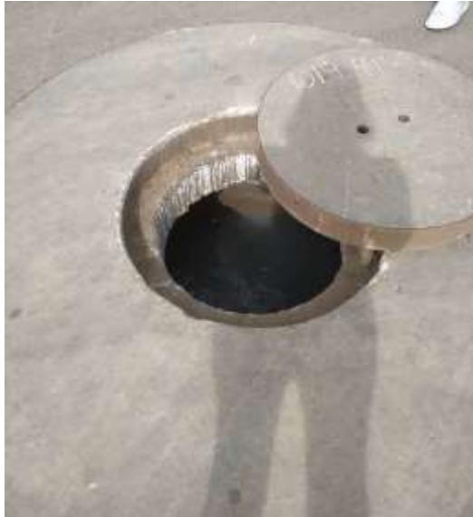
Imagen 34 Cámara de inspección Cali (Pance)
