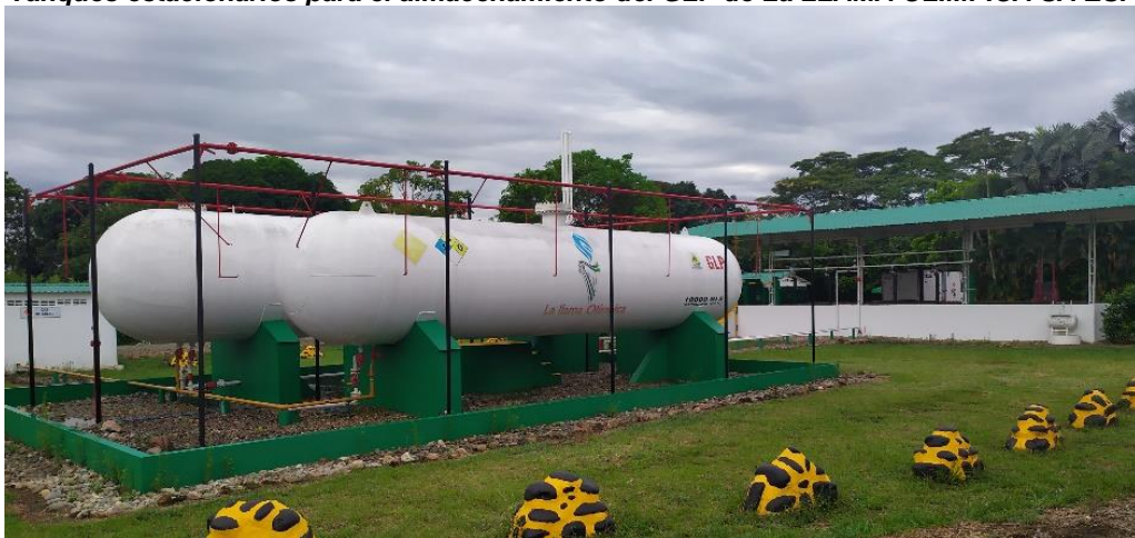
Tanques estacionarios para el almacenamiento del GLP de La LLAMA OLÍMPICA SA ESP
