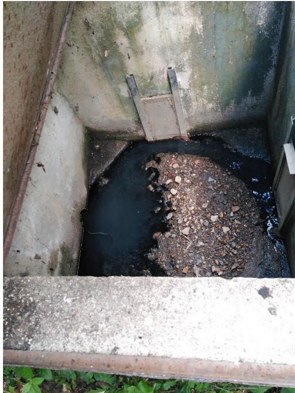
Imagen 26. Sistema de tratamiento de aguas residuales. Fuente: Visita SSPD, 2017
