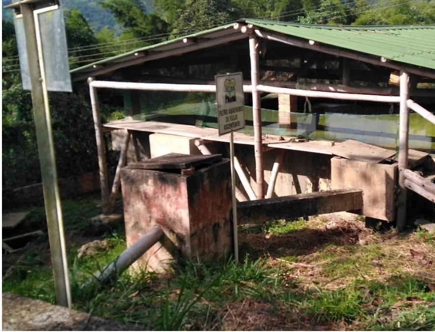
Imagen 23. Filtro anaerobio de flujo ascendente y cámara de separación de flujos. Fuente: Visita SSPD, 2017
