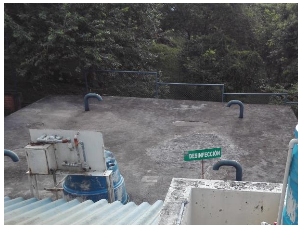
Imagen 17. Tanque de almacenamiento ubicado en la planta.
