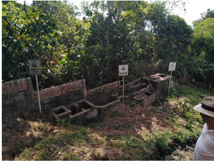
Imagen 19. Planta de tratamiento de aguas residuales. Fuente: Visita SSPD, 2017
