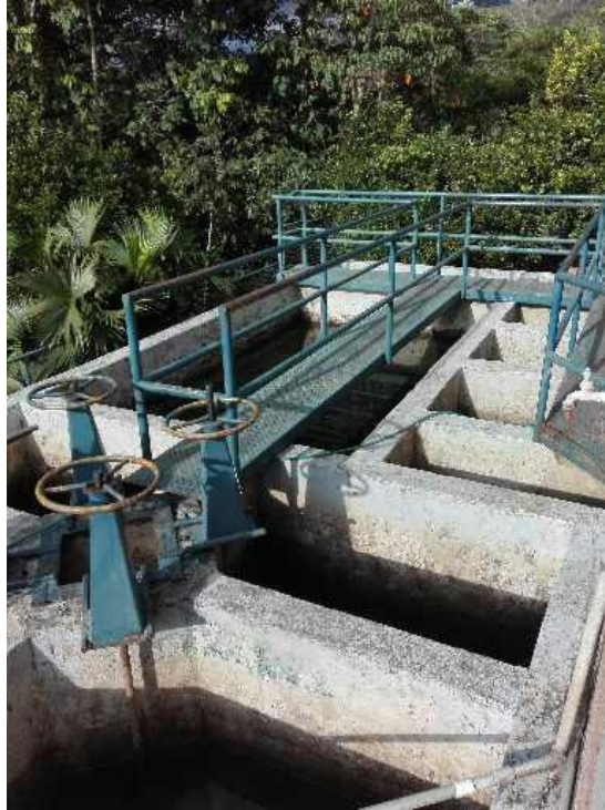
Imagen 10. Módulos, PTAP. Fuente: Visita SSPD, 2017.
