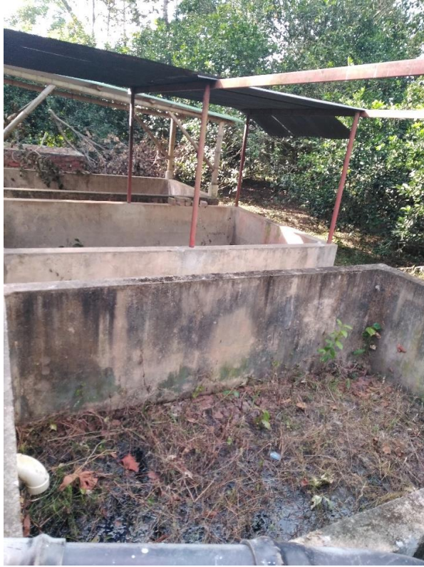
Imagen 25. Sistema de tratamiento de aguas residuales. Fuente: Visita SSPD, 2017
