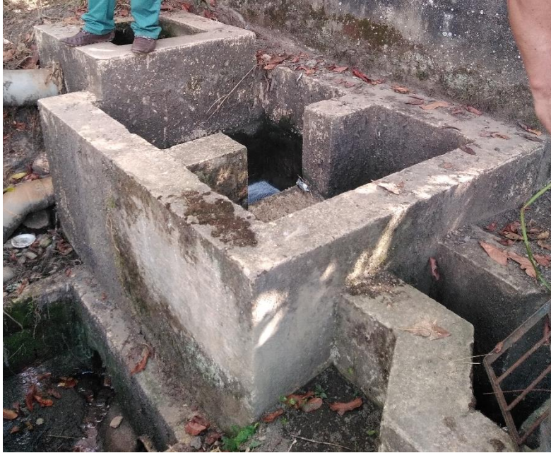
Imagen 21. Cámara de quiebre de velocidad. Fuente: Visita SSPD, 2017
