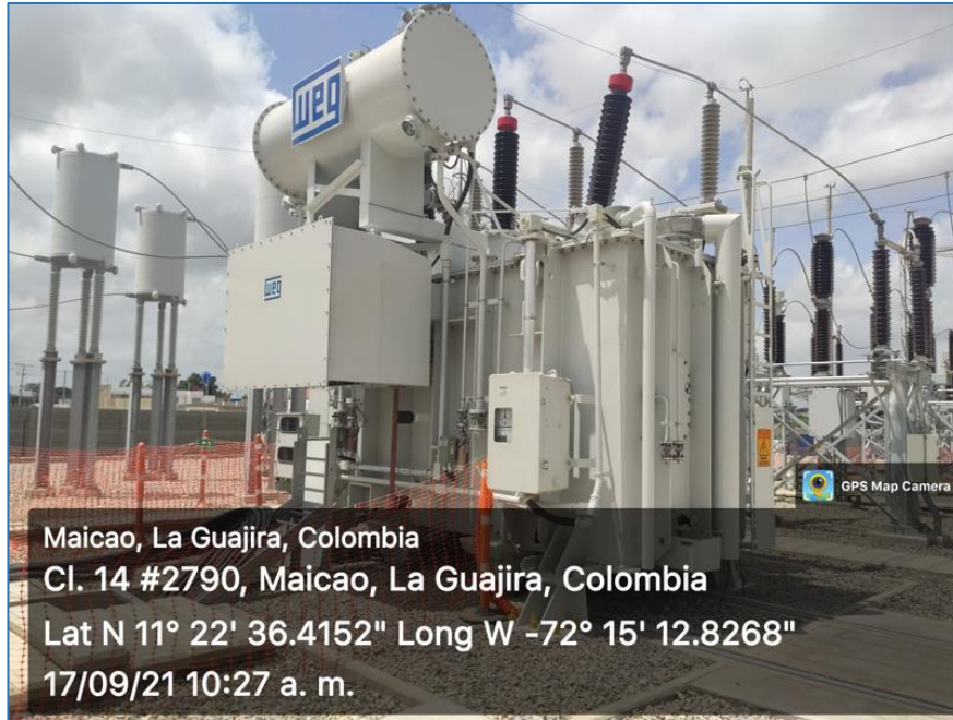
Imagen 1. Foto Nuevo transformador de 30 MVA SE Maicao
