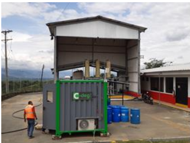
Foto 36. Vista general planta de tratamiento de lixiviados
