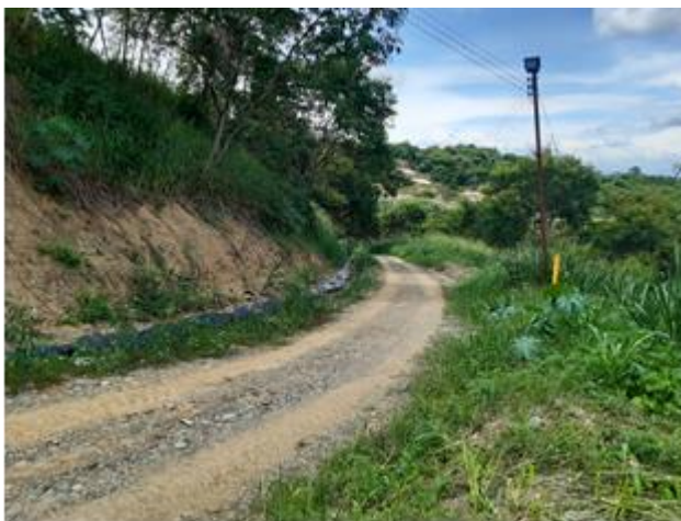
Foto 45. Vía y cuneta alrededor del vaso 1 clausurado. Nótese necesidad de corte de césped
