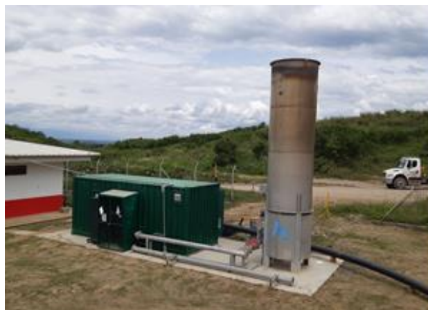
Foto 29. Sistema de extracción y quema de biogás
