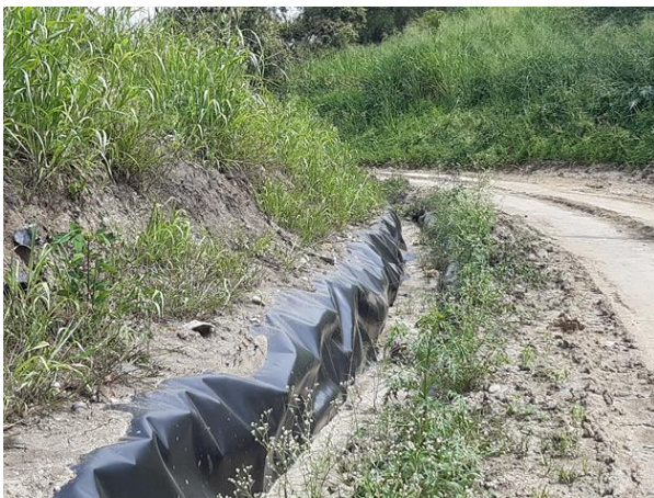
Foto 43. Vía y cuneta alrededor del vaso 1 clausurado. Nótese necesidad de corte de césped
