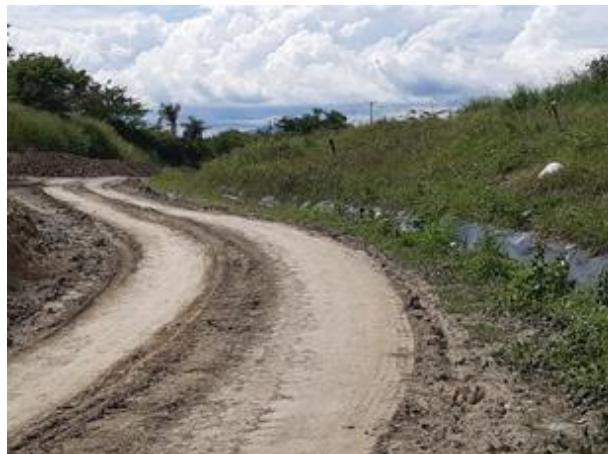
Foto 44. Vía y cuneta alrededor del vaso 1. Nótese necesidad del corte de césped
