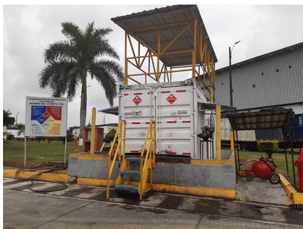
Foto 20. Zona de almacenamiento de combustible.
