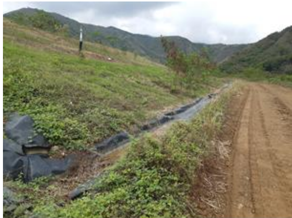
Foto 49. Canales perimetrales de aguas lluvias en zonas clausuradas
