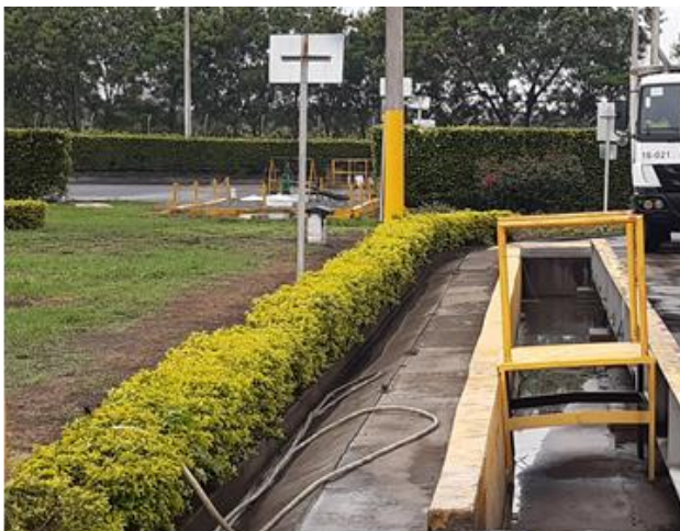
Foto 11. A la izquierda. Tanque soterrado para almacenamiento de lixiviados.
