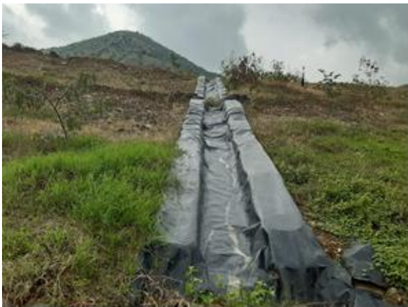
Foto 48. Canales de aguas lluvias en zonas clausuradas
