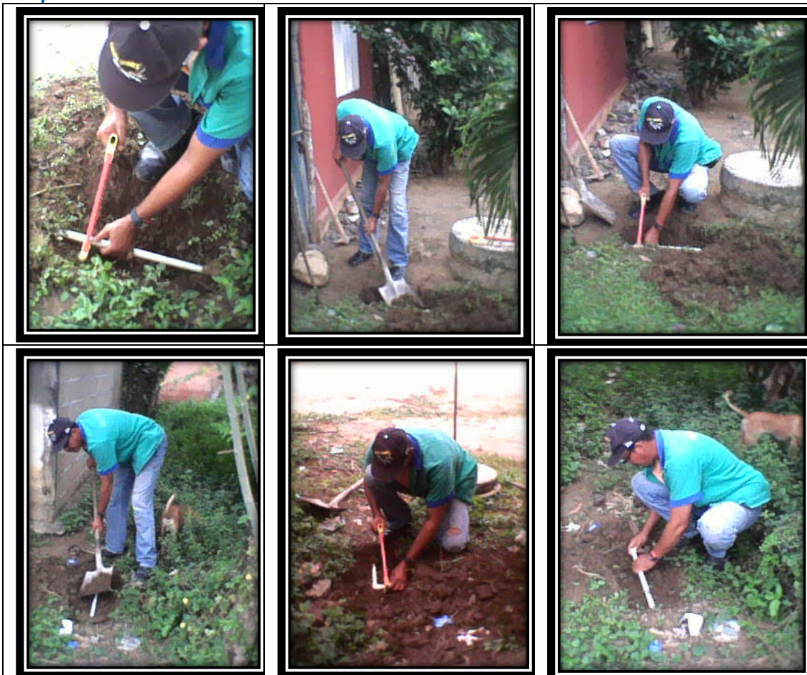
Fotos 13, 14, 15, 16, 17 y 18. Trabajos de cortes y suspensiones del servicio de acueducto por incumplimiento de lo expuesto en los Capítulos V y VI – Título II - del Decreto 302 de 2000 que reza las causales de suspensión de los servicios y Causales de corte y finalización del contrato. Durante este mes las actividades estuvieron situadas en los barrios Buenos Aires y San Juan de las Palmas.
