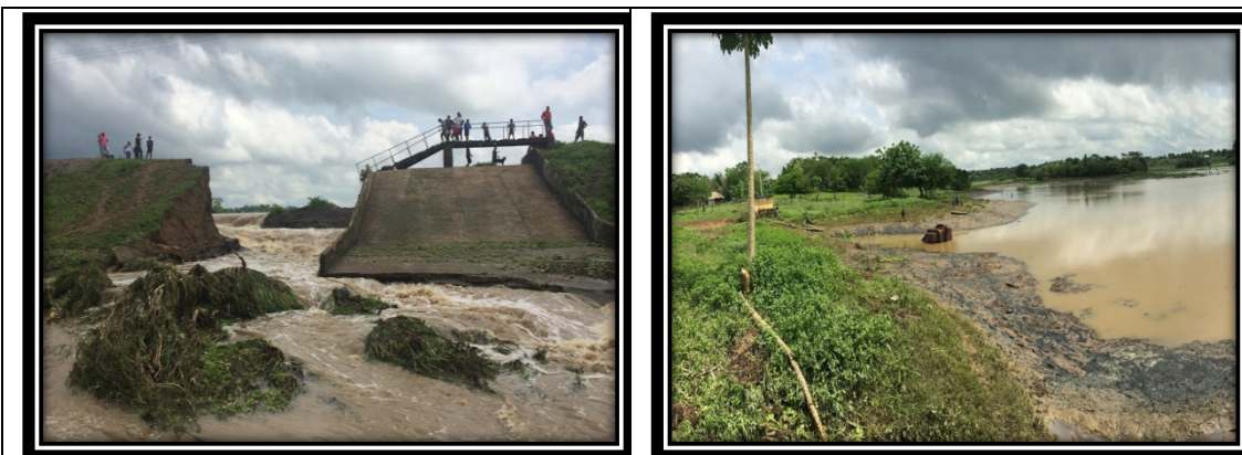
Foto 32 y 33: Emergencia presentada el día 12 de mayo a causa de desplome de estructura de vertimientos en el embalse.
