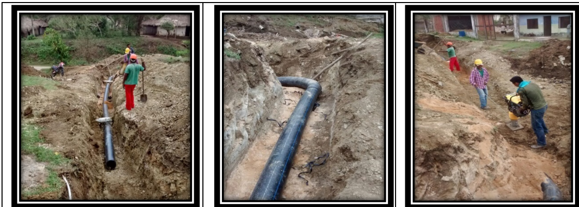
Foto 25, 26 y 27. Actividades adelantadas en la instalación de nuevo tramo de EBAP Las Cruces hasta Tanque elevado ubicado en el municipio de San Andrés de Sotavento en tubería PEAD de 8" en aras de optimizar red de impulsión.
