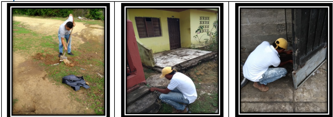
Fotos 40, 41 y 42. Trabajos de cortes y suspensiones del servicio de acueducto por incumplimiento de lo expuesto en los Capítulos V y VI – Titulo II - del Decreto 302 de 2000 que reza las causales de suspensión de los servicios y Causales de corte y finalización del contrato, las actividades se realizaron en diferente sectores del municipio.
