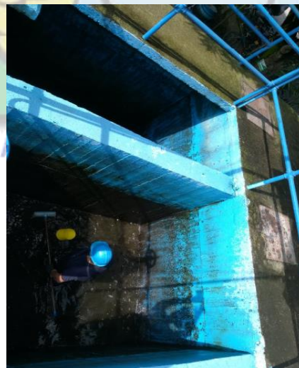
Fuente, tomada desde los lechos filtrantes.
