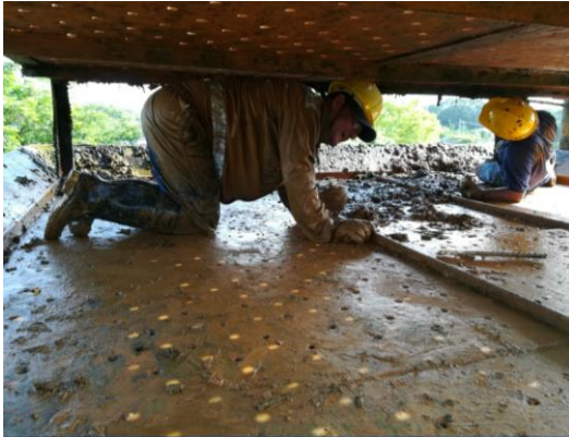
Fuente, tomada desde la torre de aireación.
