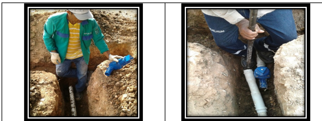
Foto 173 y 174. Instalación de válvulas de compuerta 2" en barrio Santa Catalina, municipio de San Antero.
