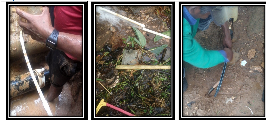
Fotos 22, 23 y 24. Trabajos de cortes y suspensiones del servicio de acueducto por incumplimiento de lo expuesto en los Capítulos V y VI – Titulo II - del Decreto 302 de 2000 que reza las causales de suspensión de los servicios y Causales de corte y finalización del contrato, las actividades estuvieron situadas en los barrios Venezuela, Santa Lucia, Centro y San Antonio.
