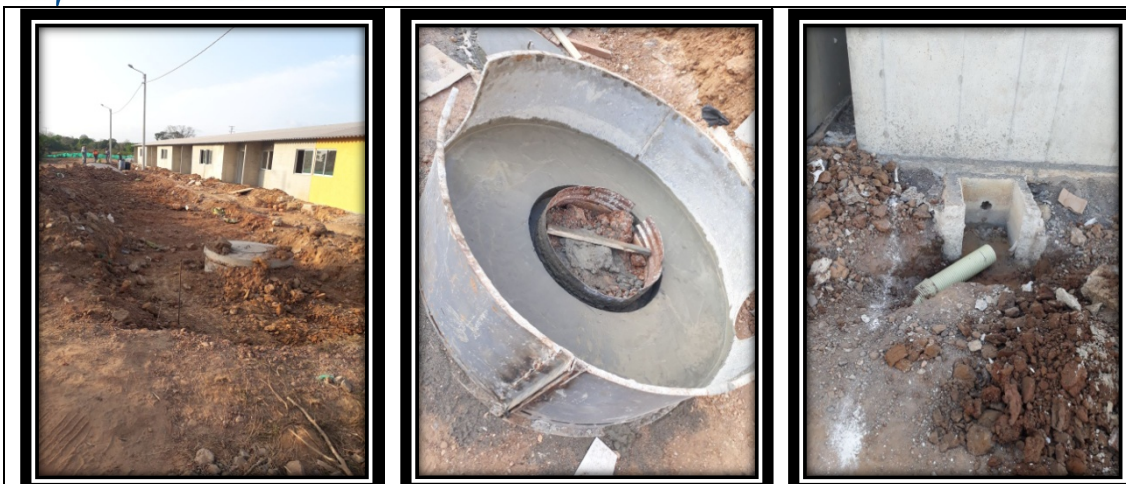
Fotos 107, 108 y 109 . Evidencia fotográfica de la construcción de nuevas camaras de inspeccion y nuevos tramos de alcantarillado en el municipio de Momil.
