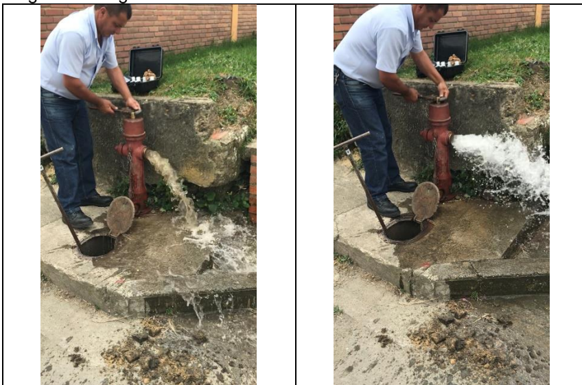
Figura 6. Purga en el hidrante del restaurante escolar
