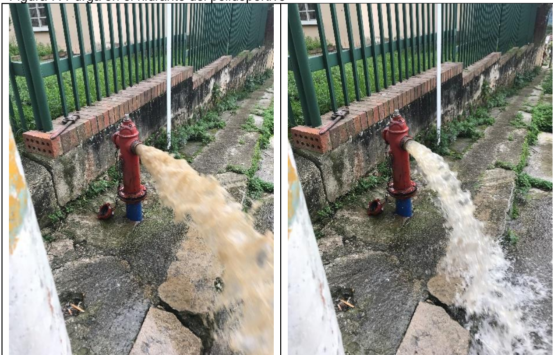
Figura 7. Purga en el hidrante del polideportivo
