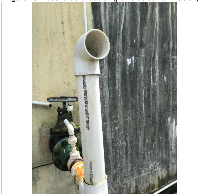
Figura 10. Tubería de aireación (punto de contaminación)
