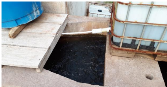
Entrada al sistema – Canaleta Parshall
