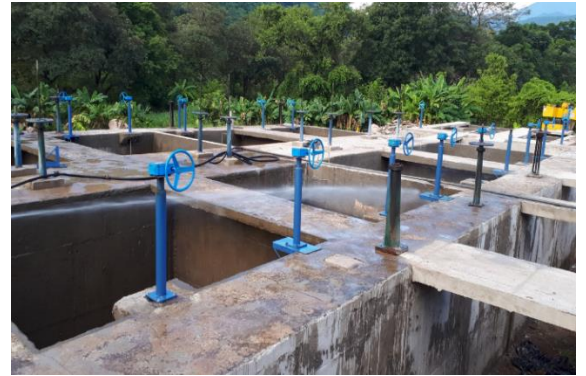
Lavado de Filtros
