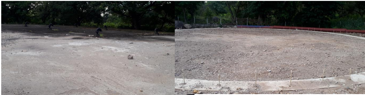
Tanque de almacenamiento PTAP – Fuera de servicio.
