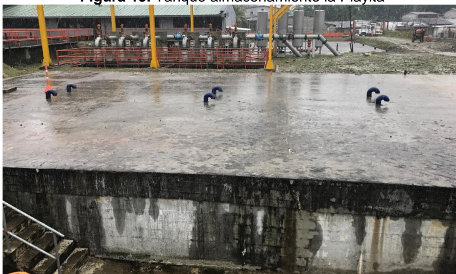
a. Tanques enterrados Sistema de Tratamiento la Playita
