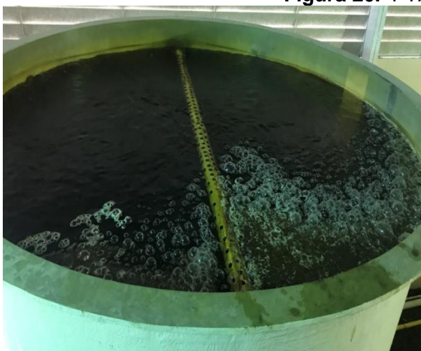
a. Módulo Floculador - sedimentador
