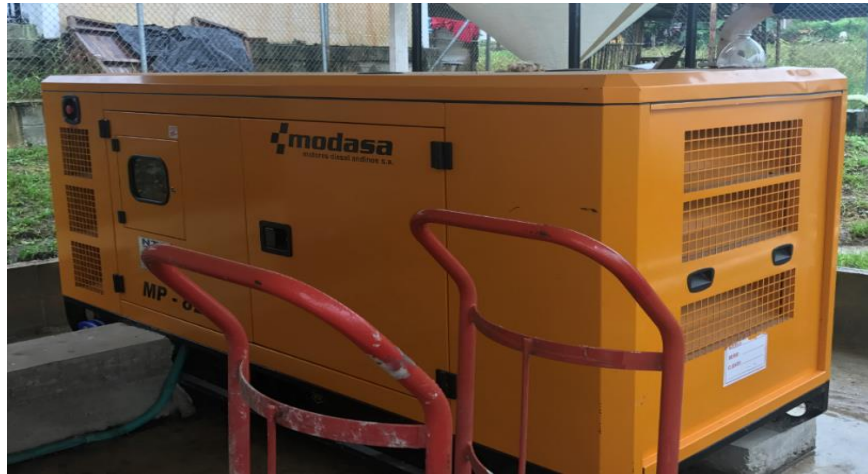
e. Planta electrica alterna
