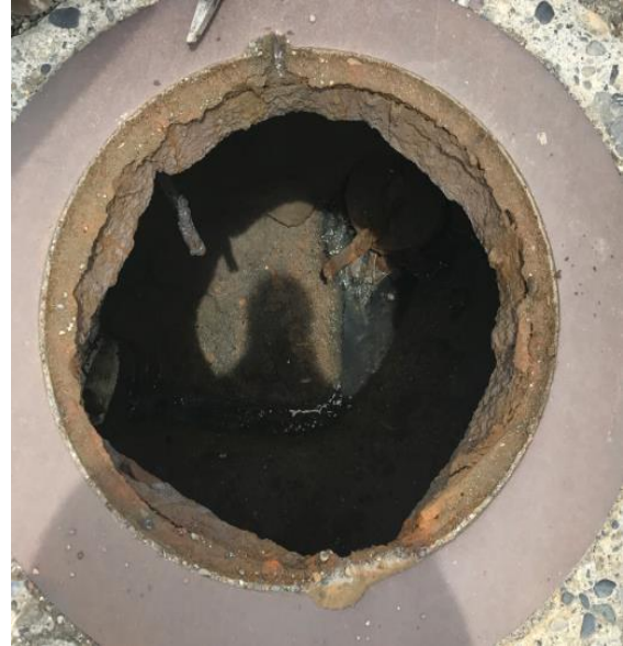
b. Carrera 6 con calle 28 centro: colmatado
