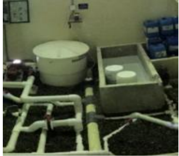
d. Tanque Desinfección
