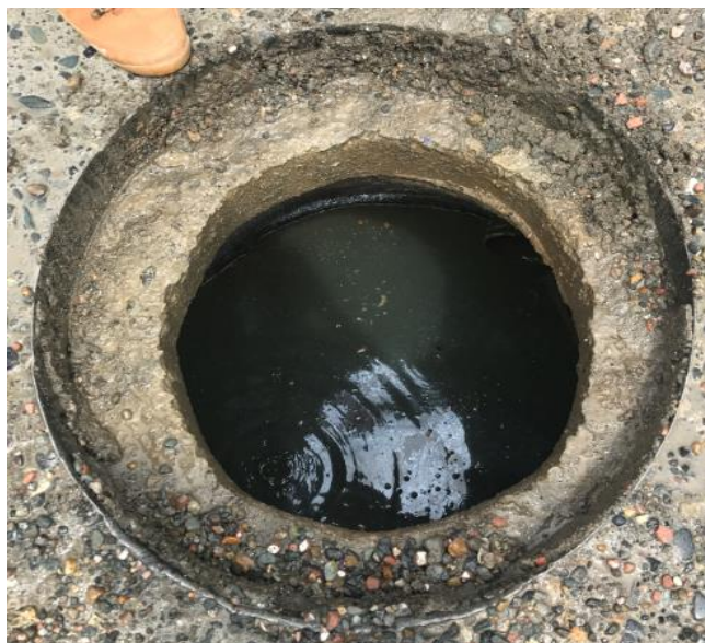
e. Carrera 1 con calle 25: se pudo observar colmatado
