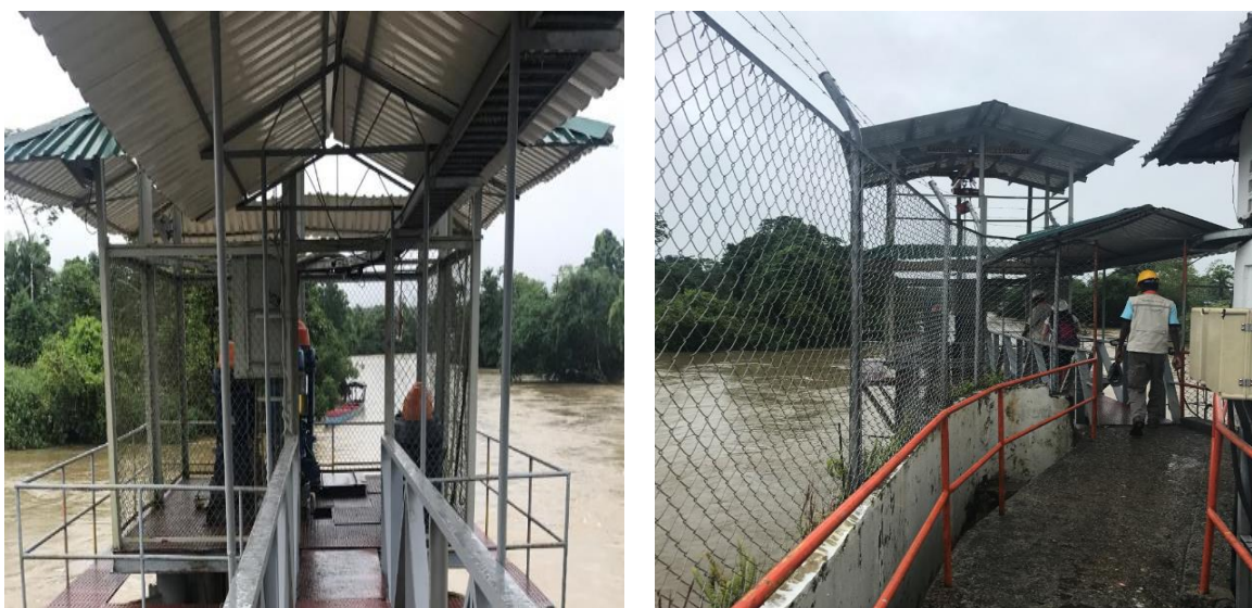
a. Caseta de Bombeo
