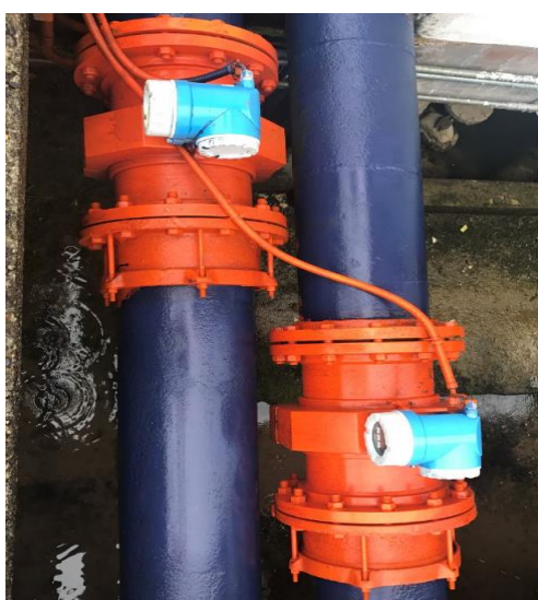
a. Macromedidores en la aducción
