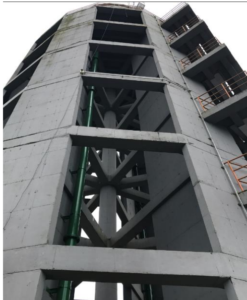
a. Tanque Elevado Zona Minera
