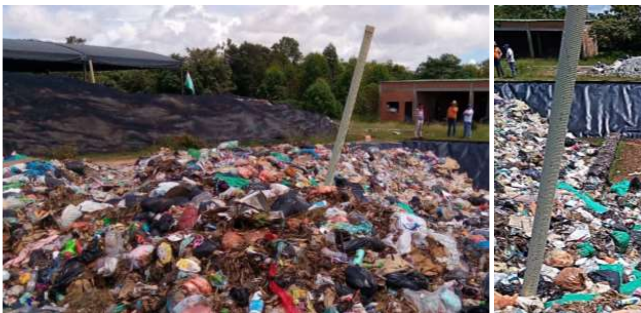
Imágenes 68 y 69: Se observan las chimeneas de evacuación pasiva de gases de las celdas 2 y 3.
