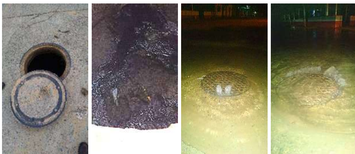
Imágenes 25 a 28: Inspección de pozos de inspección del alcantarillado de Cravo Norte a la fecha de la visita (junio de 2017); cuando en horas de la noche y bajo condiciones de lluvias intensas, se evidenció rebose en estas estructuras.
