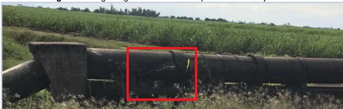
Figura 17. Fuga Registrada en el Municipio de Puerto Tejada
