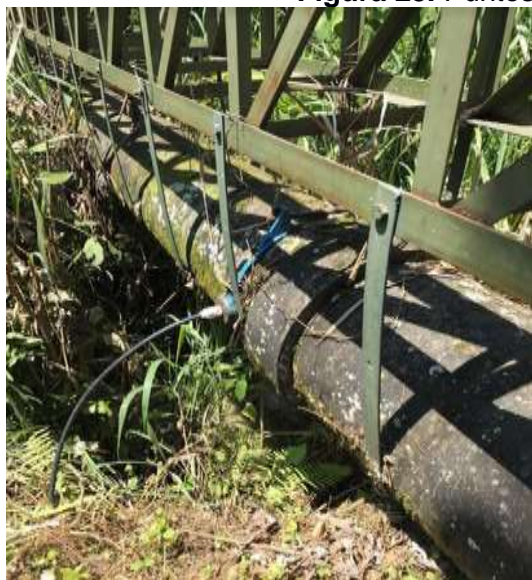
a. Punto salida del tanque de almacenamiento
