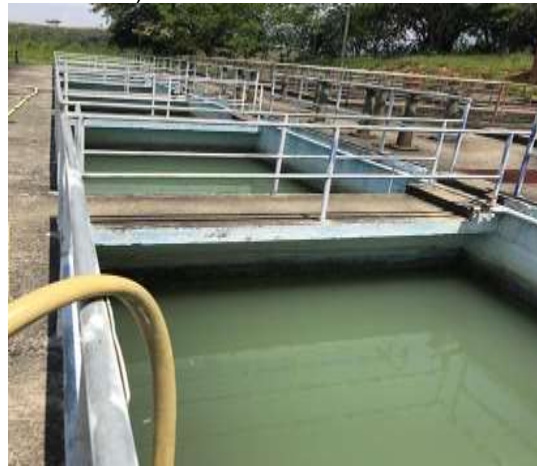
d) Tanques de filtración
