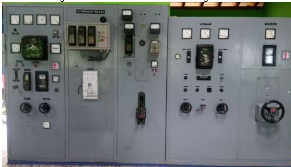
Imagen No. 4. Tableros de control de los generadores
