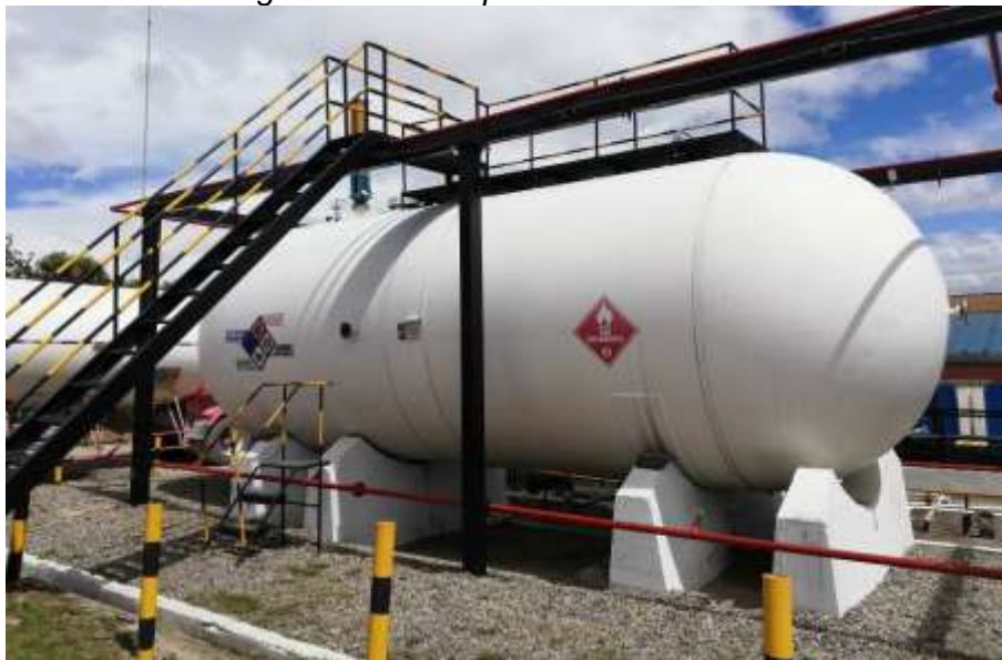
Imagen No. 5. Tanque de almacenamiento
