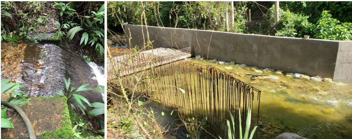
Imagen 9. Captación de las quebradas La Laucha (izq.) y La Blanca (der.), en construcción, del acueducto de Durania.
