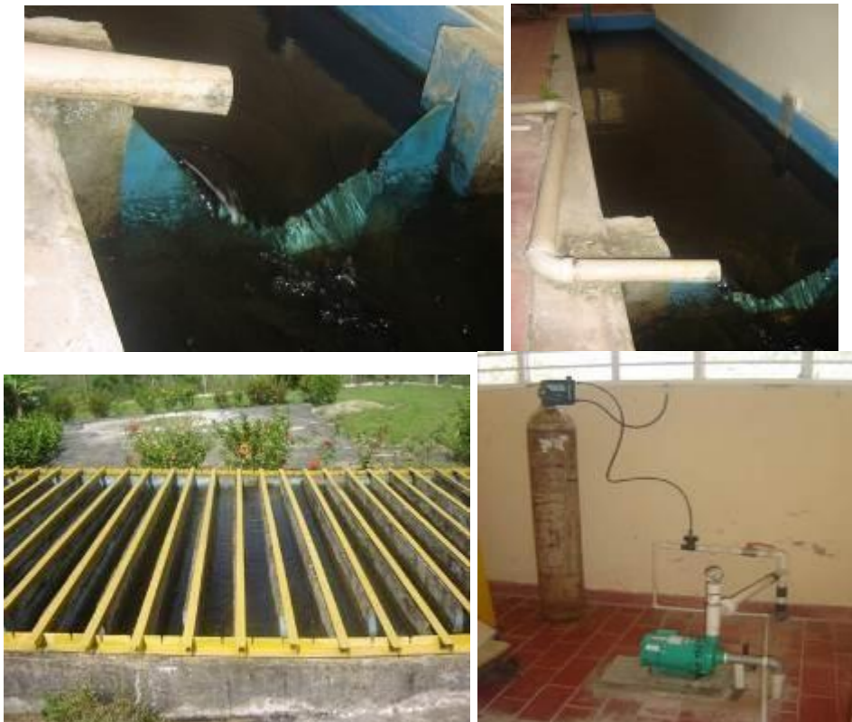
Imagen 12. PTAP del acueducto urbano de Durania.
