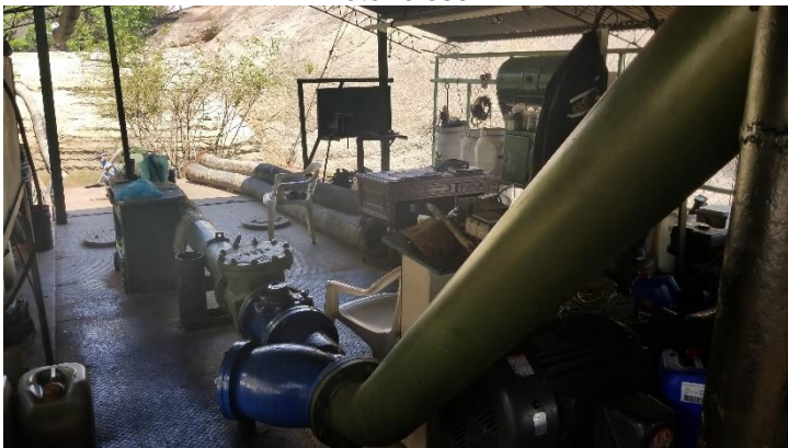
Tubería de impulsión
