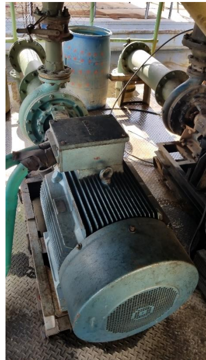
Unidad de bombeo
