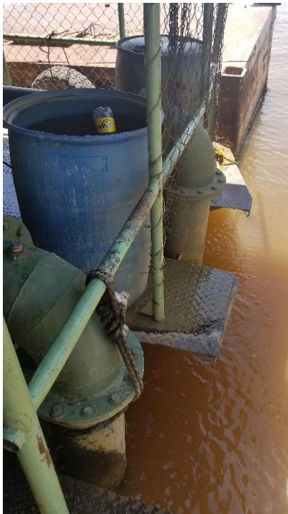
Tuberías de succión
