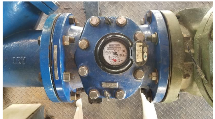
Macromedidor de agua captada
