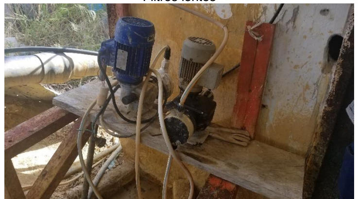
Bombas dosificadoras de coagulante
