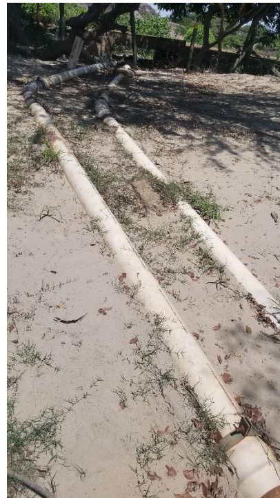
Tuberías de aducción
