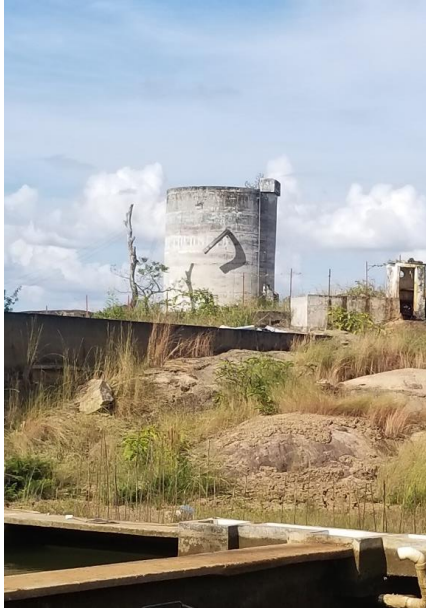
Tanque de floculación – Fuera de servicio
