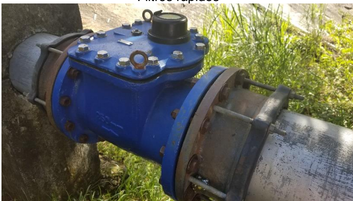
Macromedidor a la salida de la planta
