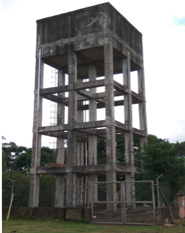
Imagen 10 Tanques de Almacenamiento El Totumo.
