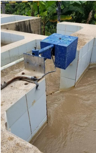
Medición de caudal a la entrada de la planta y adición de coagulante
