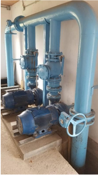
Bombeo a tanque elevado
