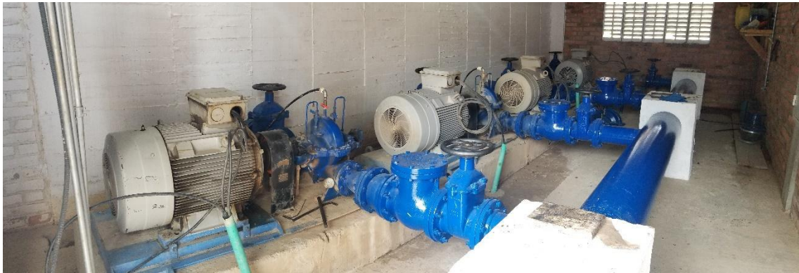
Sistema de bombeo
