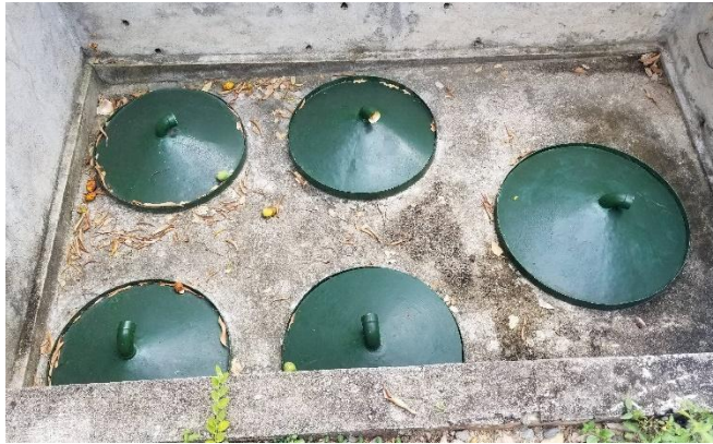
Trampas de grasas y desarenadores
