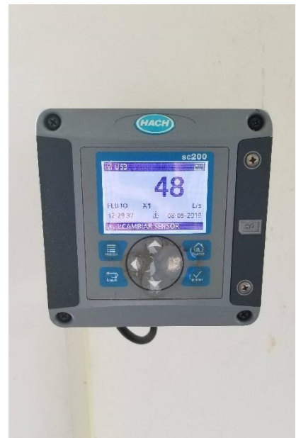
Macromedidor de entrada a la planta
