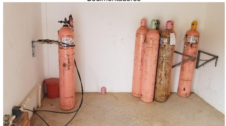
Dosificación de cloro gaseoso
