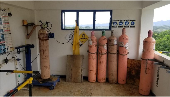
Dosificación de cloro gaseoso
