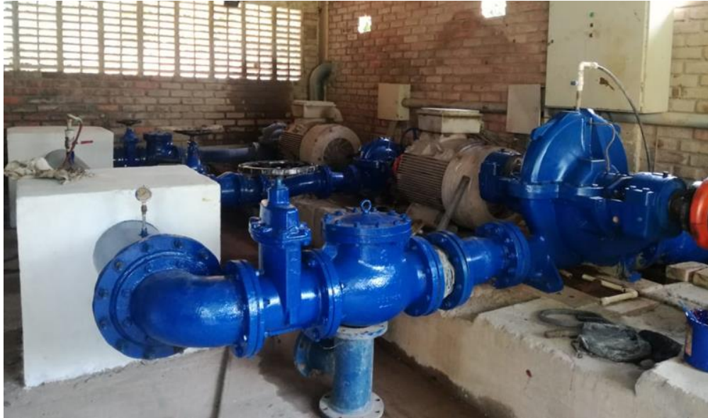
Imagen 7. Rebombeo a la salida del desarenador
