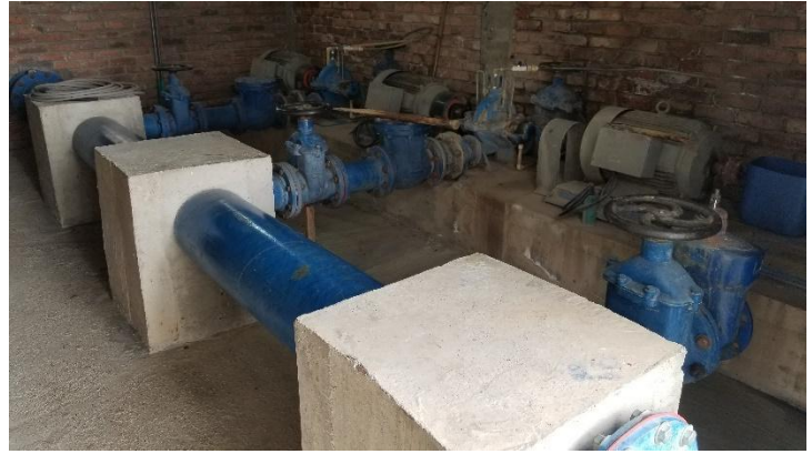
Sistema de bombeo de agua cruda hacia el municipio de Tocaima
