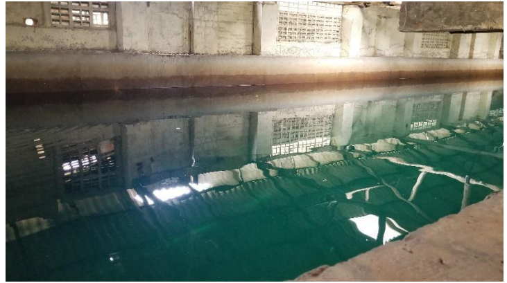
Tanque de almacenamiento
