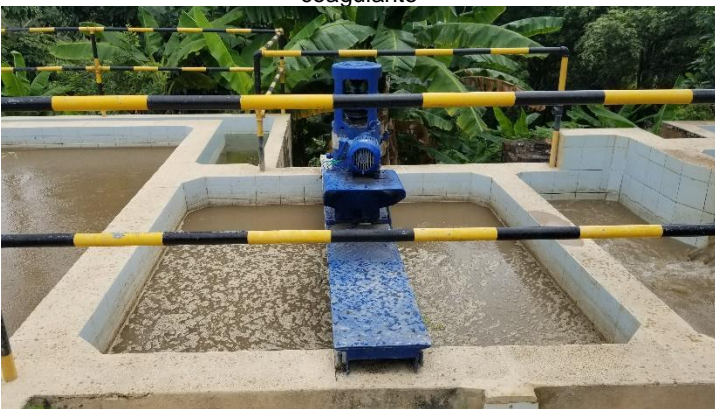
Floculador mecánico vertical
