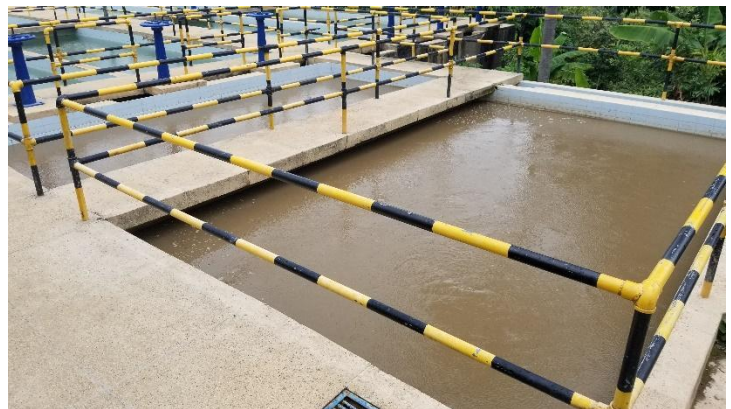
Floculadores mecánicos horizontales
