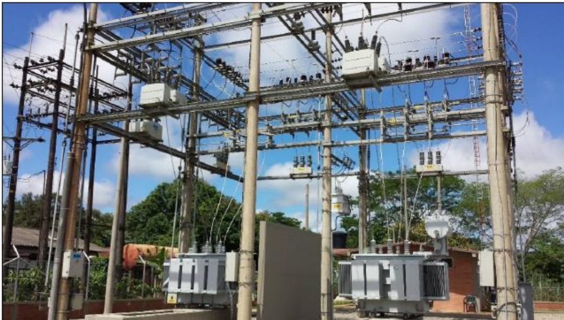
Ilustración 10 Subestación Calamar 2x2 MVA 34,5/13,8 kV
