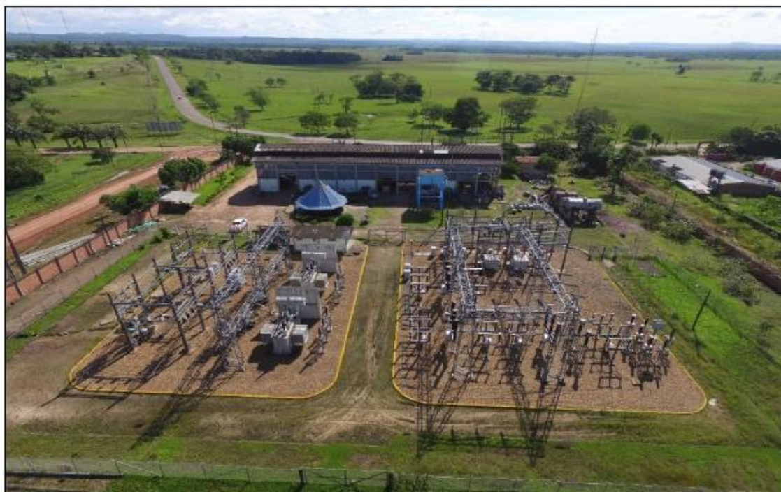
Ilustración 6 Subestación San José del Guaviare 2x10/12 MVA 115/34,5/13,8 kV
