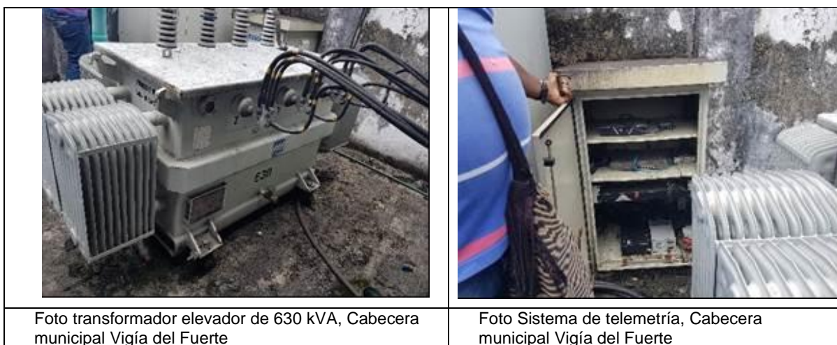
Imagen 4 Transformador Elevador – Sistema de Telemetría CNM
