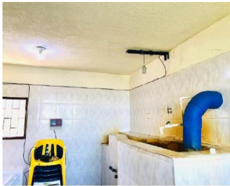
Canaleta Parshall, medidor de caudal
