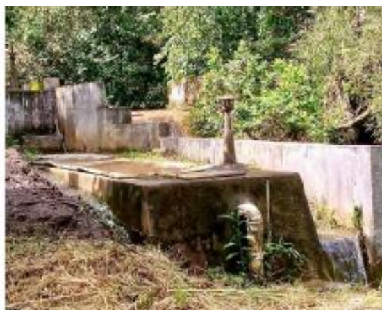
Bocatoma quebrada la Olavica
