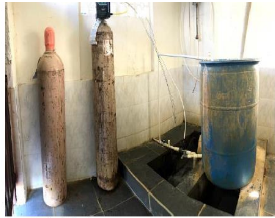
Área de desinfección
