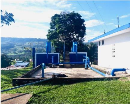
Tanque de almacenamiento No. 1
