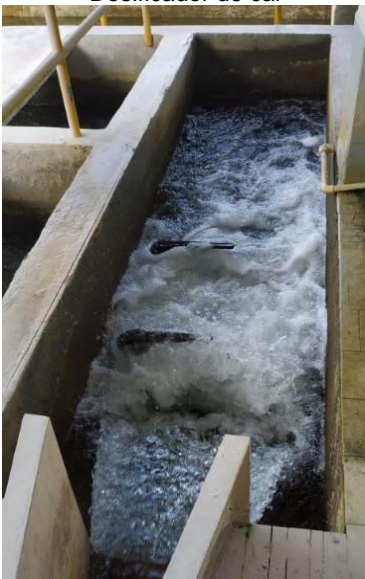
Entrada a Floculadores
