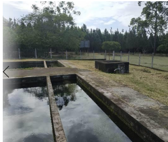
Cámara de salida y válvulas de control aguas abajo desarenador
