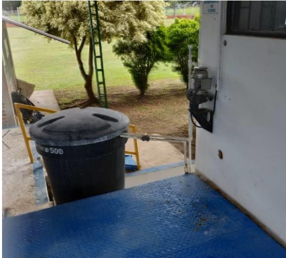
Sistema de dosificación de cloro por solución
