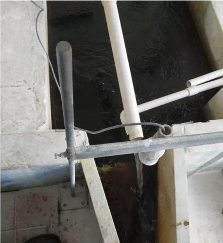
Dosificación de cal en la canaleta Parshall
