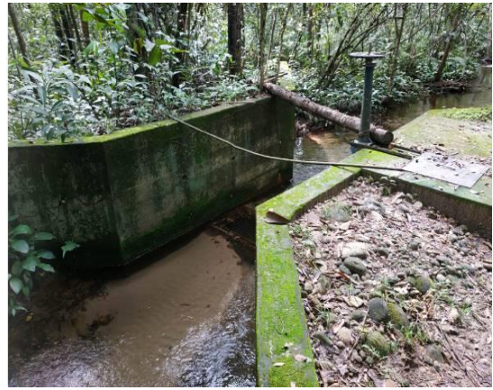
Rejilla de fondo nótese válvula de compuerta control de caudales
