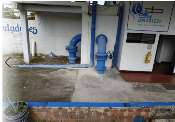
Tuberías de llegada a la planta de los desarenadores y pozos de bombeo
