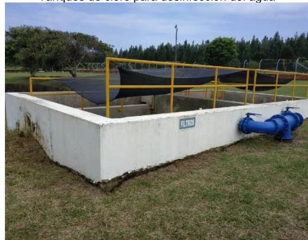
Vista de filtros
