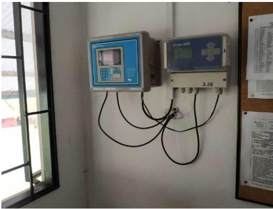
Macromedidores en funcionamiento
