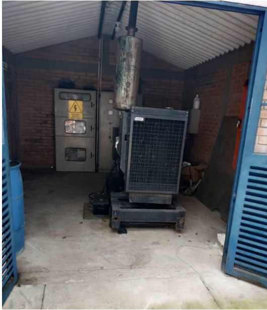
Planta de respaldo diésel para suministro de energía
