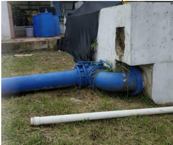
Válvulas de operación de la planta
