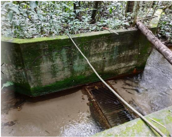
Captación lateral con muros de protección
