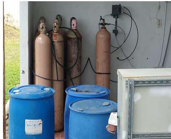
Tanques de cloro para desinfección del agua
