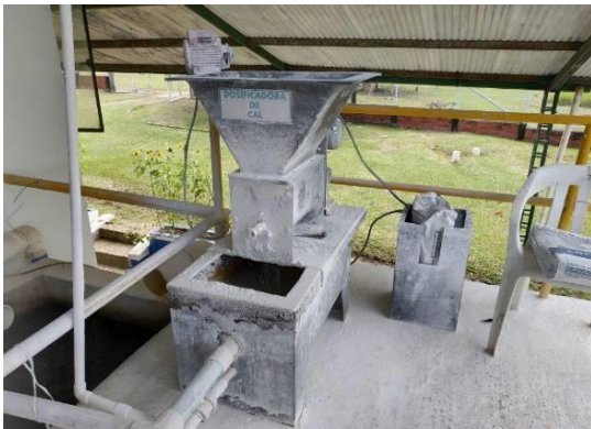
Dosificador de cal
