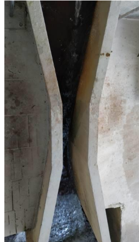
Canaleta Parshall – Medición de caudal
