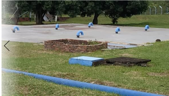
Imagen 12. Tanque de almacenamiento
