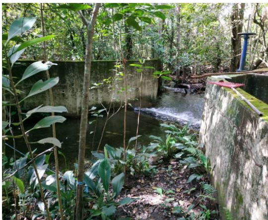
Captación lateral con muros de protección
