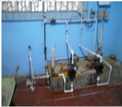
Sistema de dosificación del coagulante Fuente: Visita SSPD, octubre 2019
