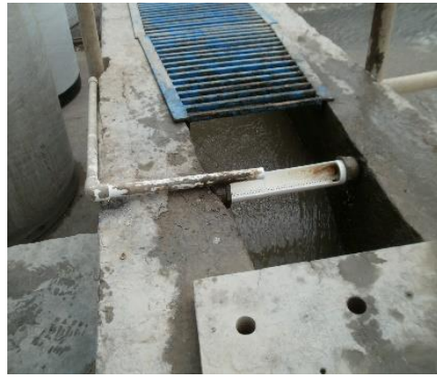
Dosificación hidroxí cloruro
