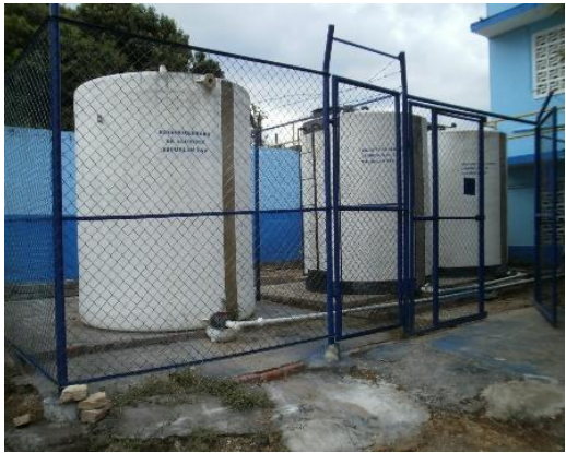
Tanques de almacenamiento de coagulante
