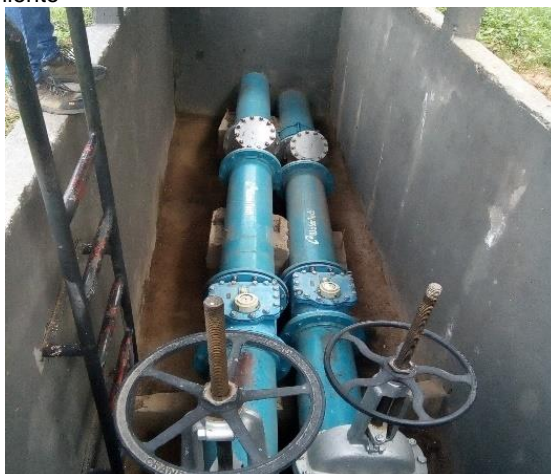
Macromedidor de salida
