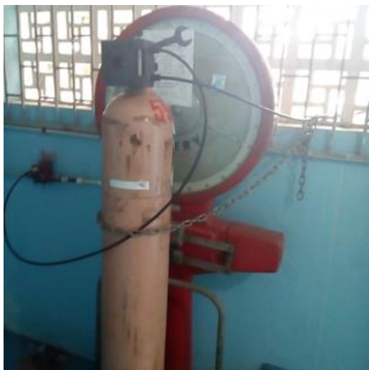
Tanque de cloro gaseoso
