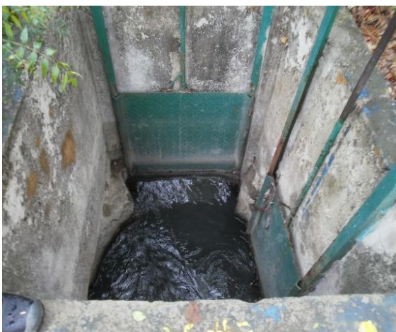
Cámara de entrada
