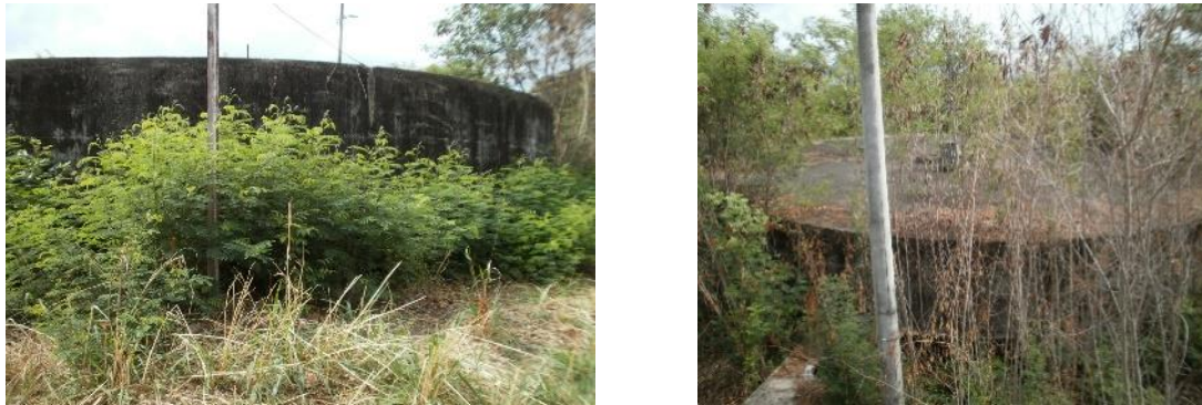
Imagen 21. Tanque de almacenamiento 1 y 2
