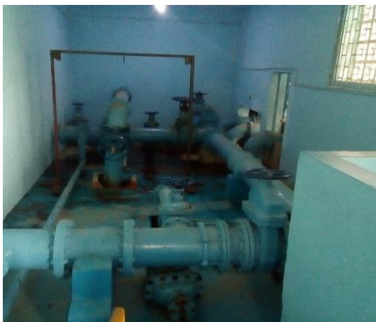
Sistema de bombeo hacia tanques de almacenamiento
