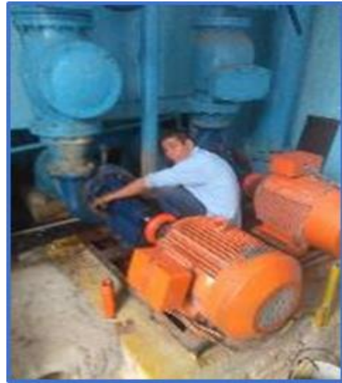
Sistema de bombeo
