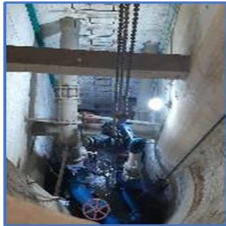
Sistema de bombeo
