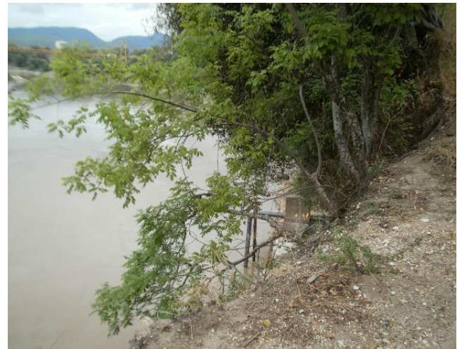
Captación de Caseta 2
