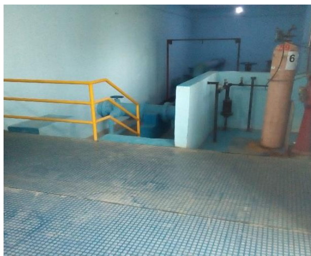
Tanque de cloración
