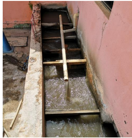
Canal de mezcla rápida
