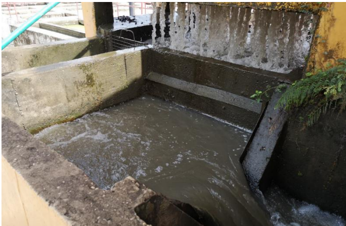
Entrada a PTAP
