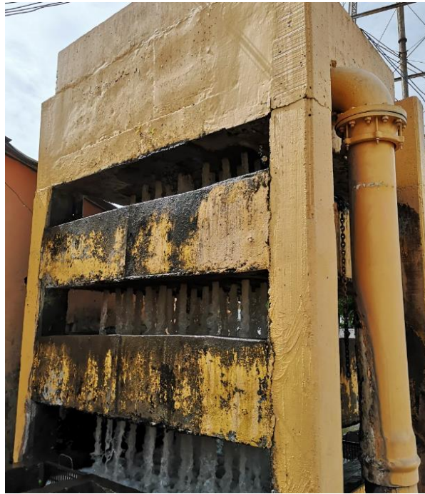
Imagen 5. Torre de aireación
