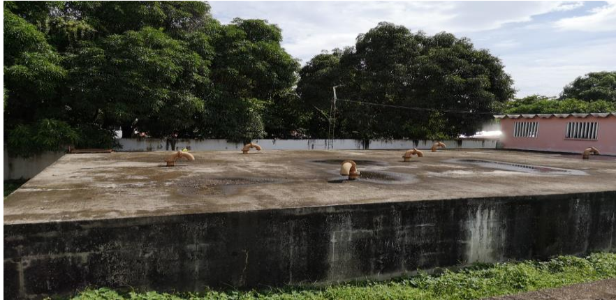
Imagen 9. Tanques de almacenamiento Planta de Tratamiento
