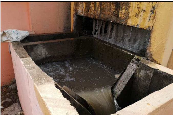
Entrada a PTAP # 1
