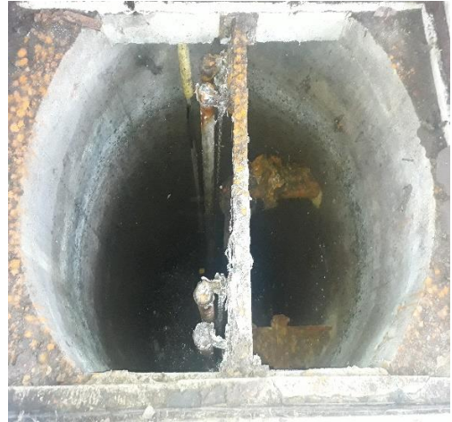
Pozo húmedo EBAR 1
