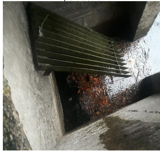
Canal de derivación / rejilla fuera de operación
