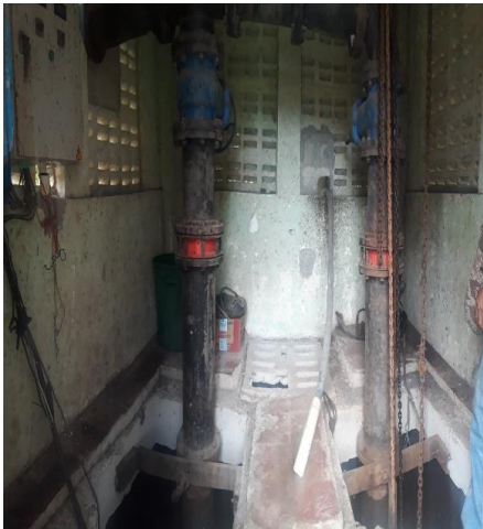
Pozo húmedo EBAR 2
