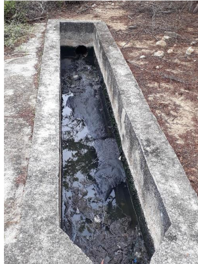
Canal de ingreso con arenas
