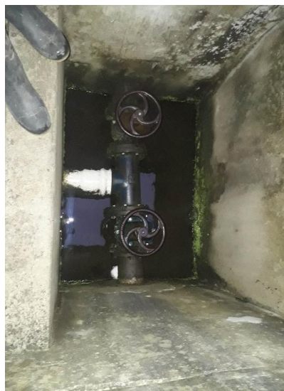
Válvula de paso tanques de almacenamiento (con fugas)
