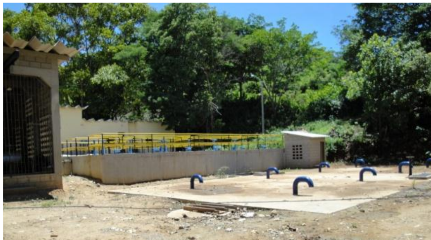
Imagen 14. Tanque PTAP acueducto Regional
