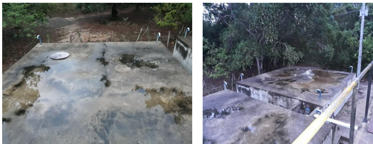
Imagen 15. Tanques de almacenamiento sistema rio Ancho
