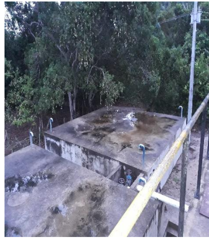
Tanques de almacenamiento
