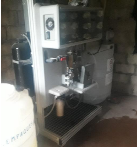
Sistema dosificación de Cloro fuera de funcionamiento
