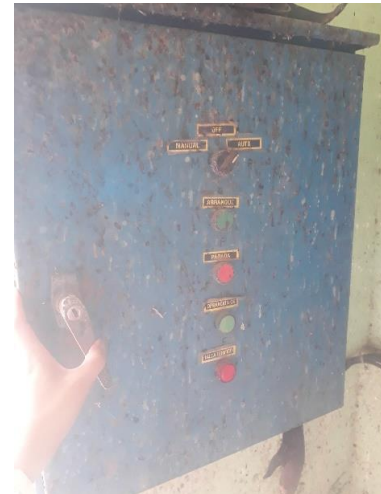
Controles eléctricos EBAR 2
