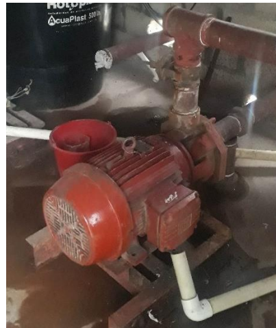
Bombeo de succión
