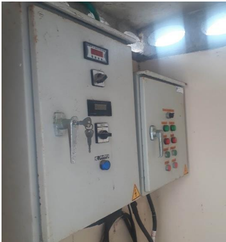
Controles eléctricos EBAR 1
