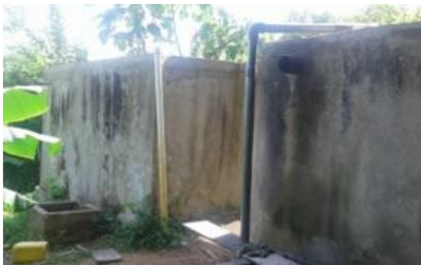
Imagen 16. Tanques de almacenamiento Palomino
