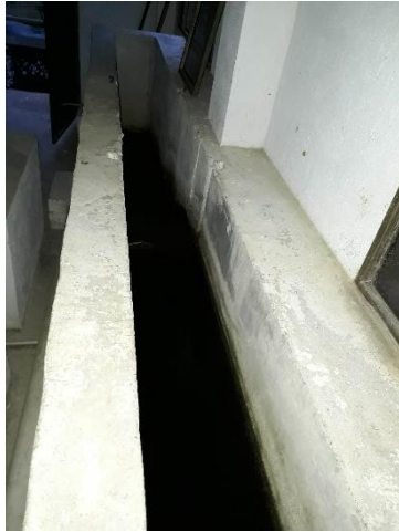
Canal de ingreso a la PTAP
