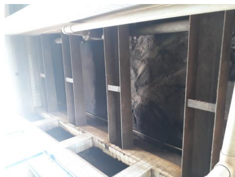
Filtro en mantenimiento
