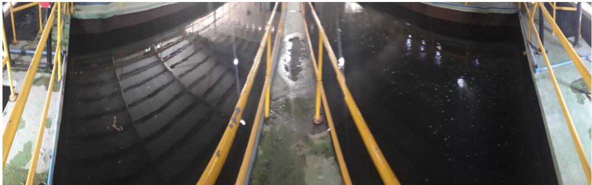
Filtros convencionales de arena
