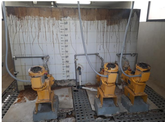
Dosificadores de Sulfato
