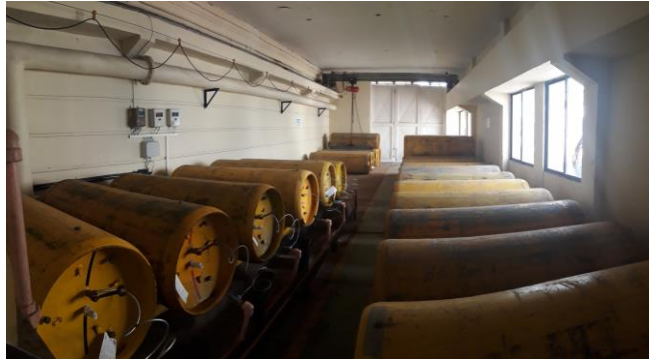
Dosificación Cloro gaseoso Fuente: Visita SSPD
