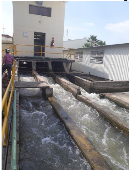
Canales de mezcla
