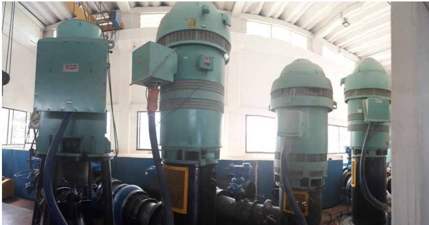
Sistema de bombeo cuarto 1
