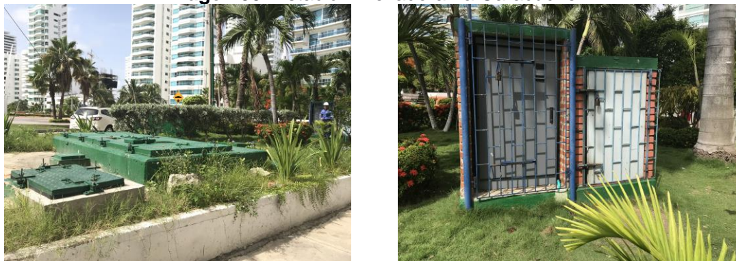
Imagen 33. Estación Elevadora La Caracuche
