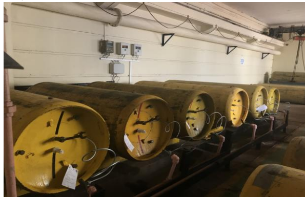
Cuarto de cloración
