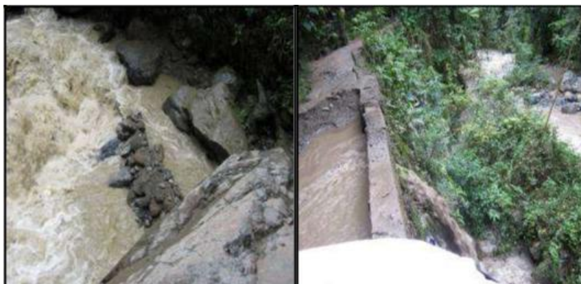
Imagen 4. Captación Quebrada La Sopetrana – Sopetrán.
