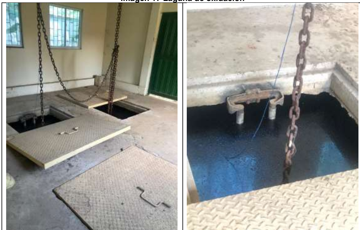
Imagen 17 Laguna de oxidación
