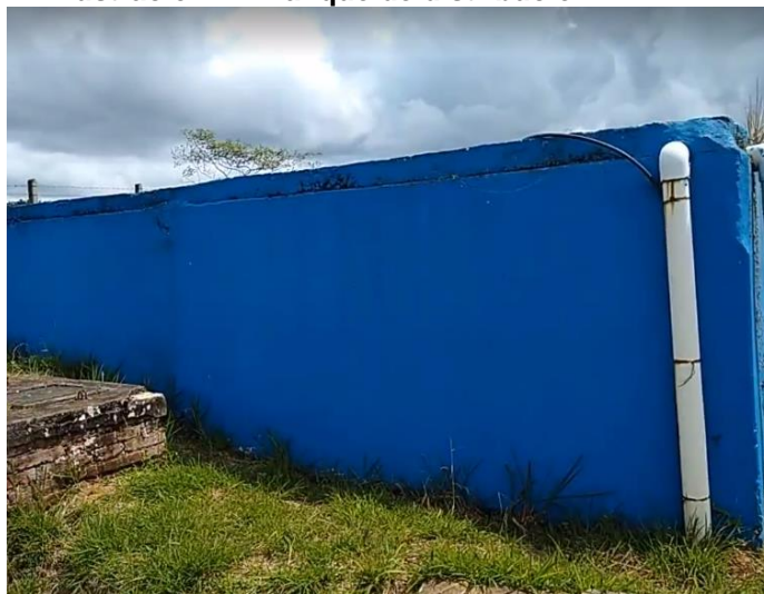
Ilustración 22. Tanque de distribución 1
