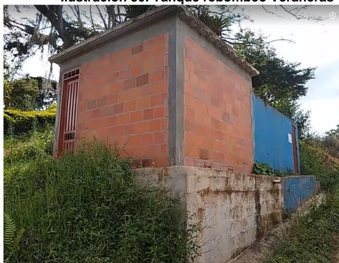
Ilustración 30. Tanque rebombeo Veraneras
