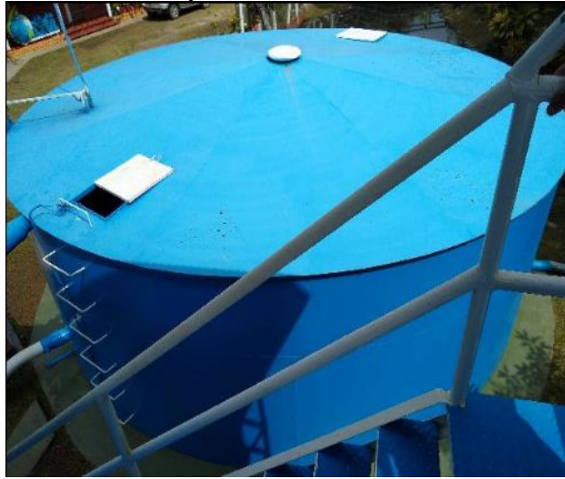
Ilustración 21. Tanque de almacenamiento PTAP
