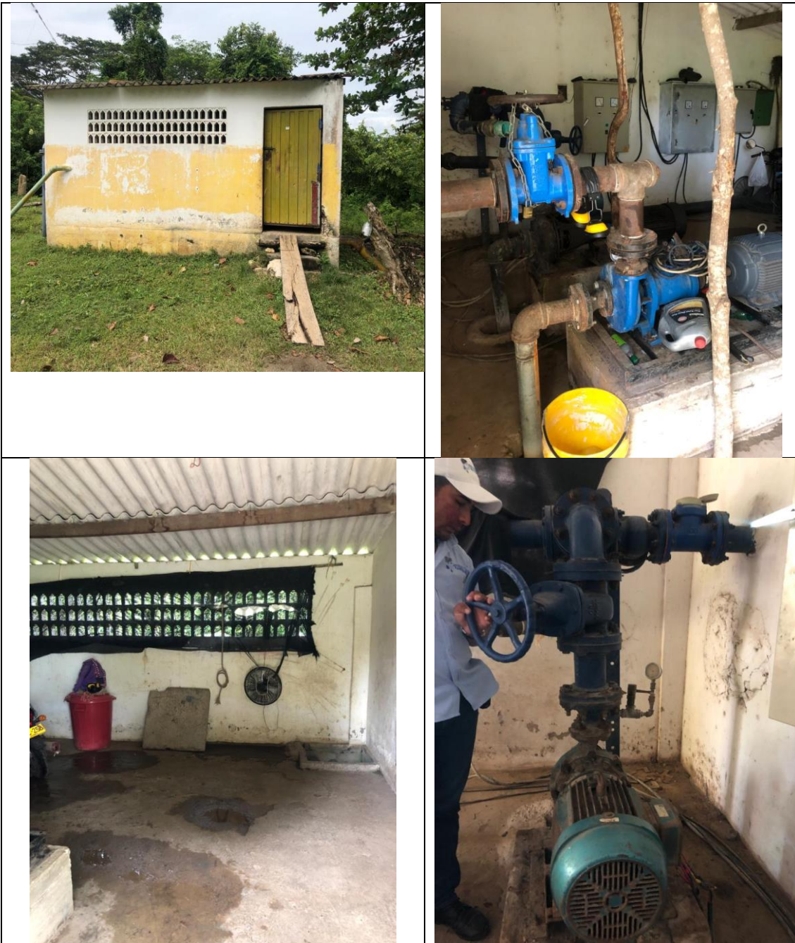
Imagen 9. Estación de bombeo
