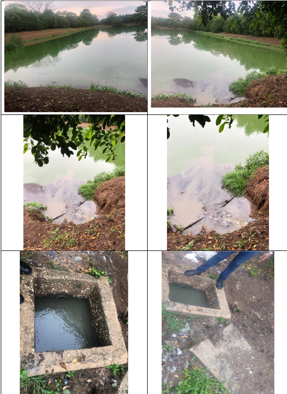
Imagen 17. Tratamiento aguas residuales, lagunas de oxidación
