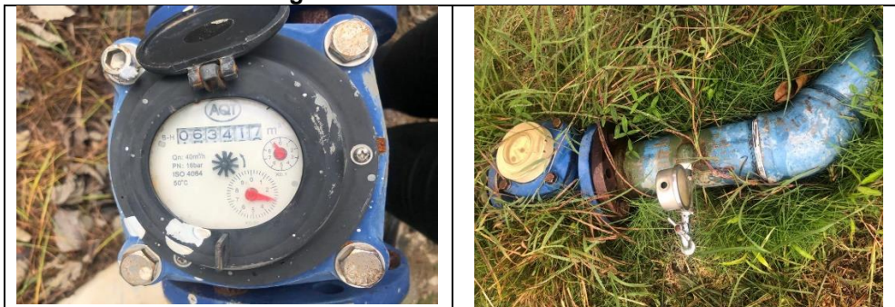
Imagen 14. Macro medición servicio acueducto
