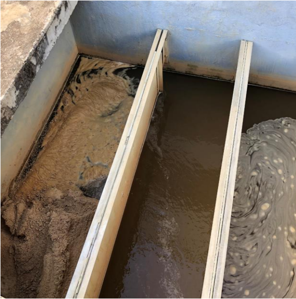
Acumulación de sedimentos en los floculadores
