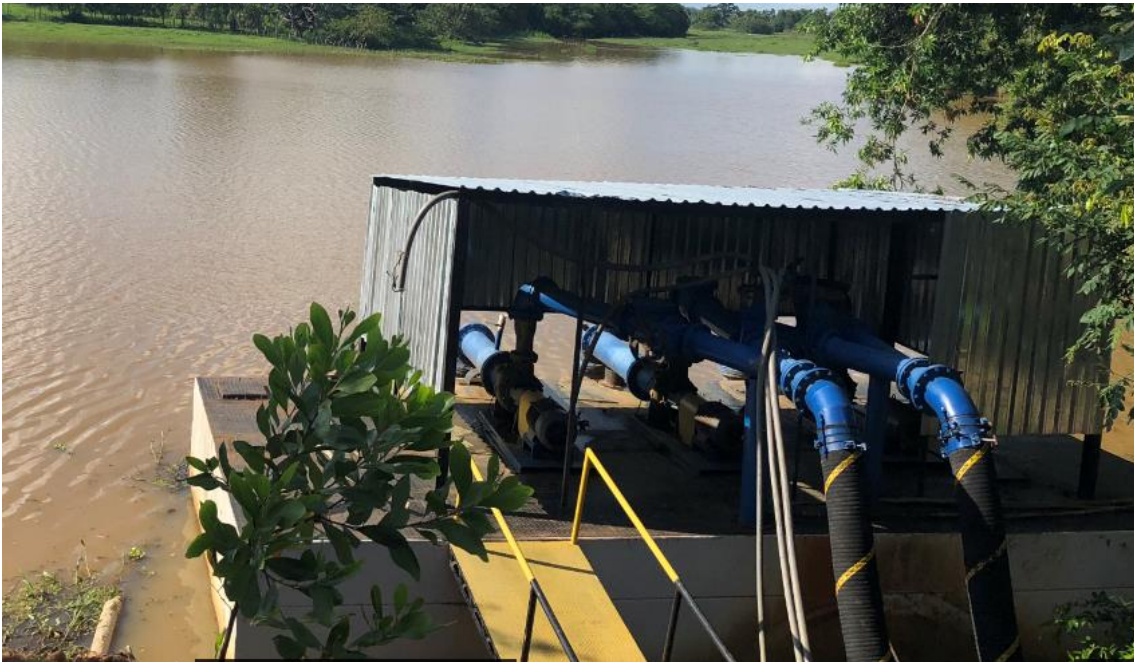
Sistema de Bombeo
