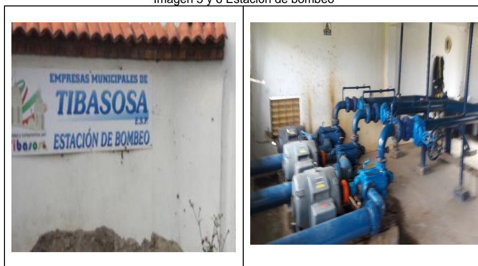
Imagen 5 y 6 Estación de bombeo
