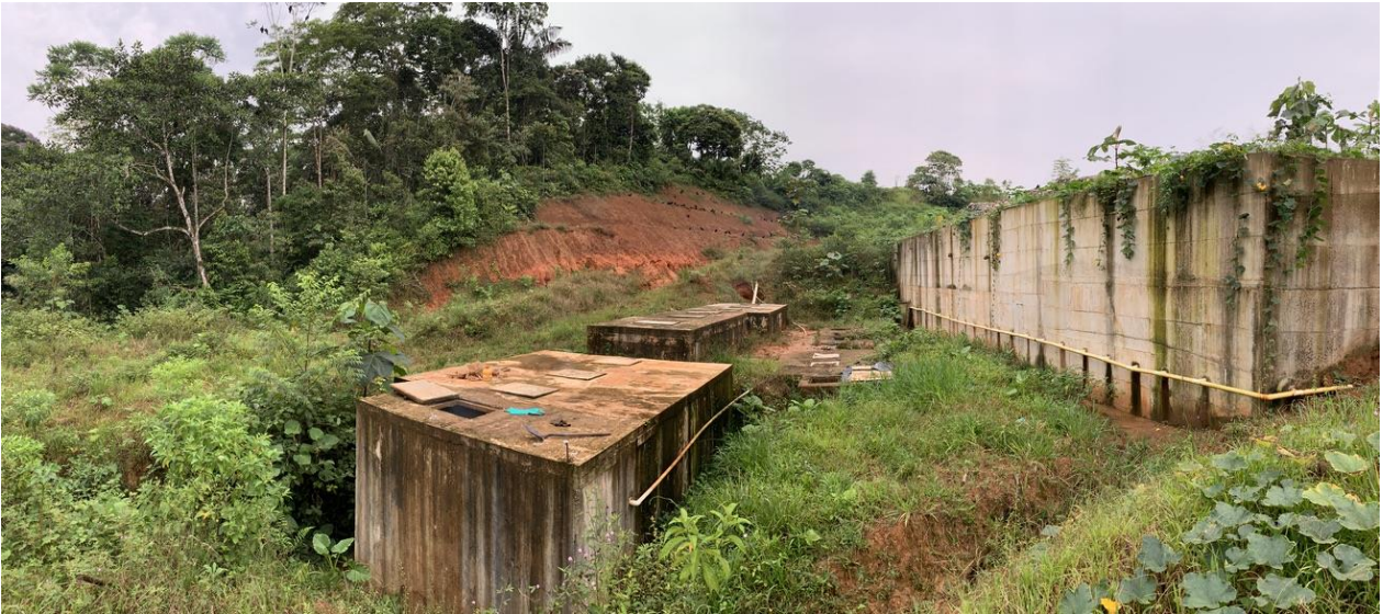
Ilustración 14. Sistema de recolección de lixiviados
