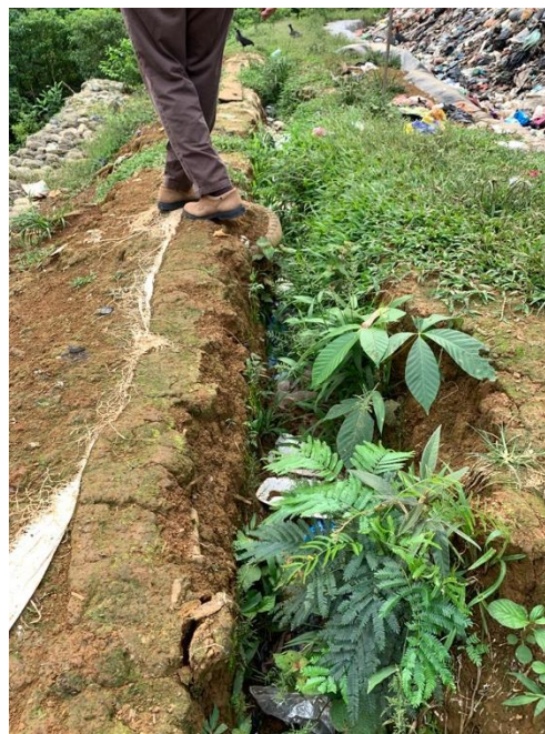
Ilustración 18. Canales perimetrales obstruidos
