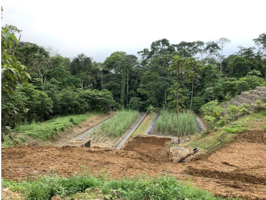
Ilustración 16. Planta de tratamiento de lixiviados
