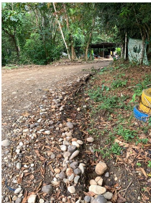
Ilustración 17. Canales perimetrales en material terreo
