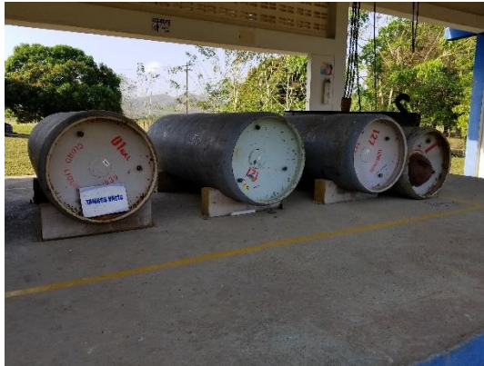
g) Tanques de cloro gaseoso.
