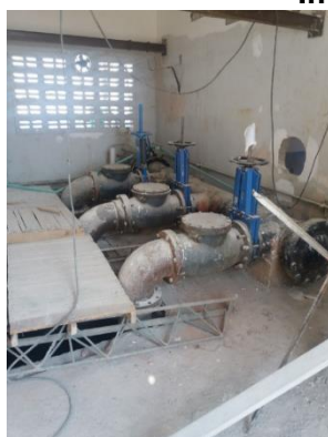
a) Sistema de bombeo.
