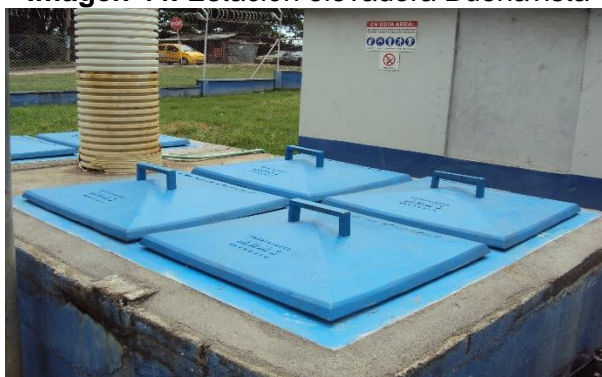
Imagen 44. Estación elevadora Buenavista
