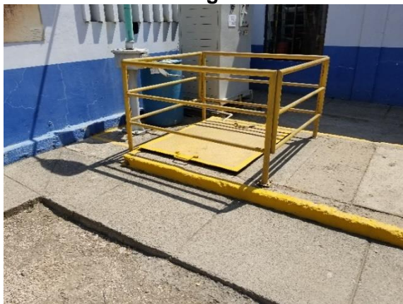
a) Estación de bombeo.
