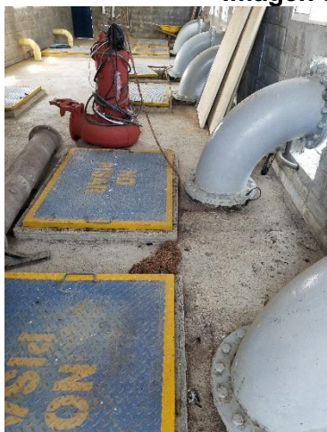
a) Sistema de bombeo.
