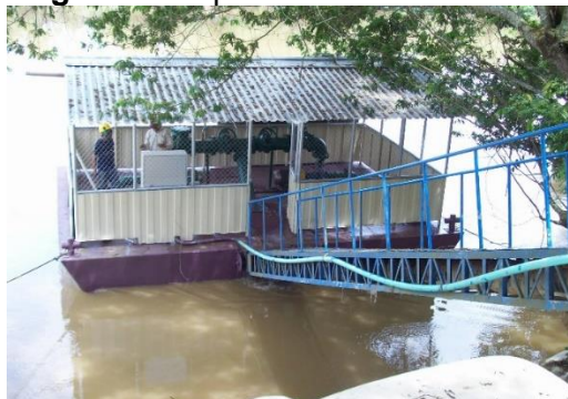
Imagen 23. Captación sistema Garzones
