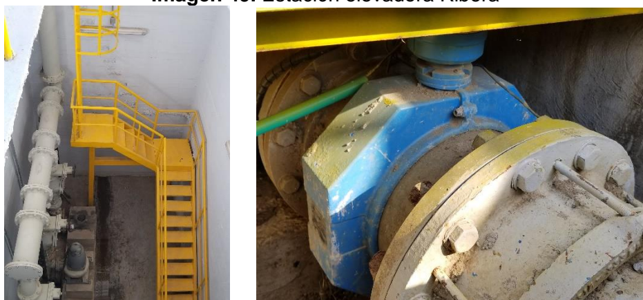
a) Sistema de bombeo, b) Equipo de macromedición.
