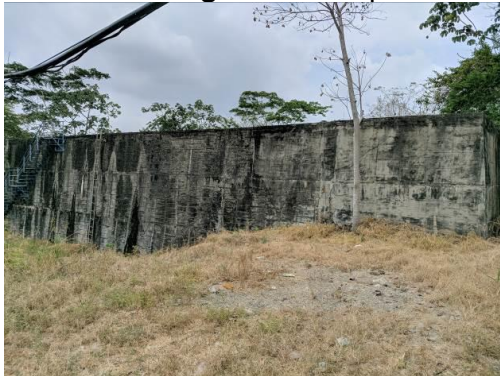
a) Tanque de 10.000 m 3 .
