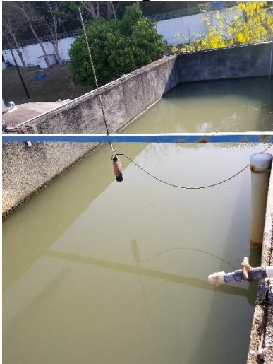
a) Estructura de entrada y macromedición.
