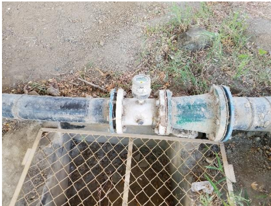
a) Macromedición captación – entrada PTAP.
