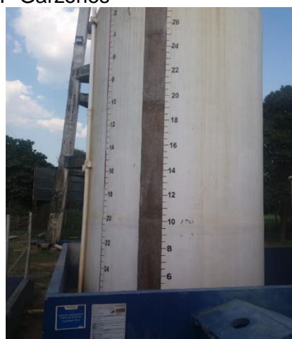
b) Dique de contención de sulfato de aluminio.
