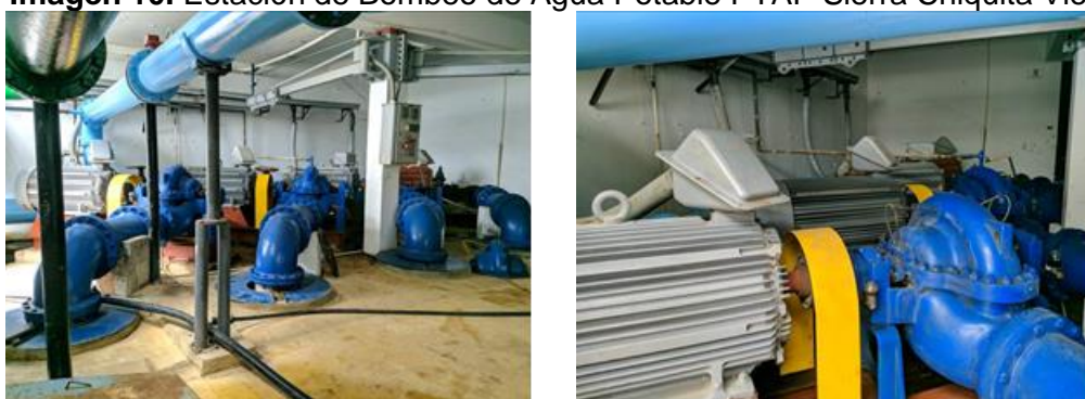
Imagen 10. Estación de Bombeo de Agua Potable PTAP Sierra Chiquita Vieja
