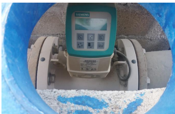
a) Macromedición captación – entrada PTAP.
