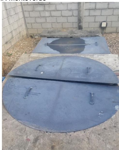
b) Sistema de bombeo.
