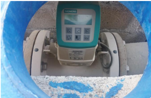
a) Macromedición captación – entrada PTAP.
