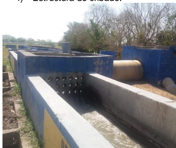
h) Estructura de cribado.
