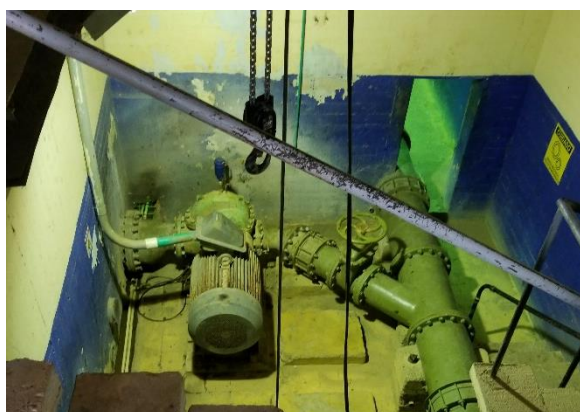
b) Sistema de bombeo.
