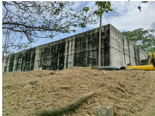
c) Tanque de 3.000 m 3 .
