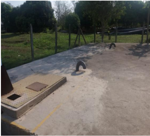
e) Tanque semienterrado.
