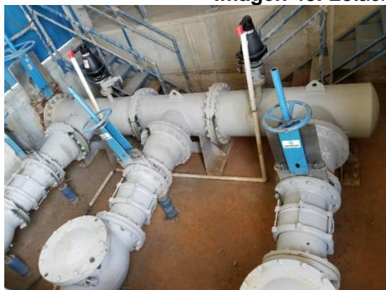
a) Sistema de bombeo.
