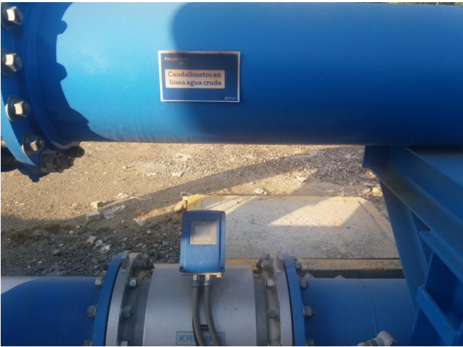
a) Macromedición captación – entrada PTAP.
