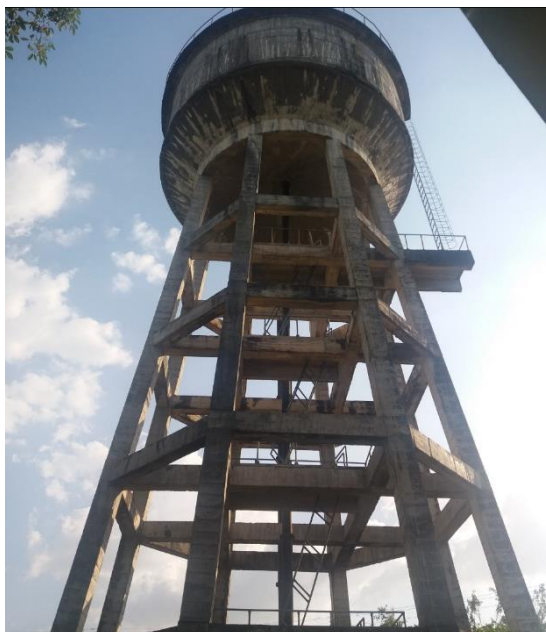
e) Tanque elevado.
