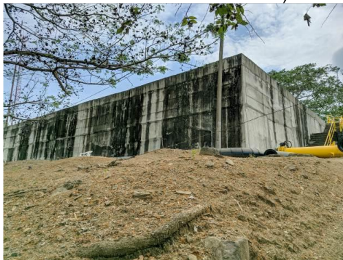
c) Tanque de 3.000 m 3 .
