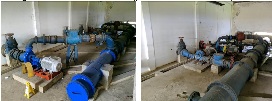
Imagen 17. Estación de Bombeo de Agua Potable PTAP Sierra Chiquita Nueva
