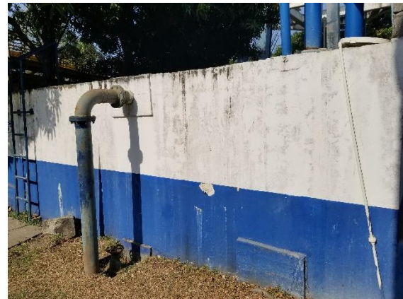
d) Tanque de cloración.
