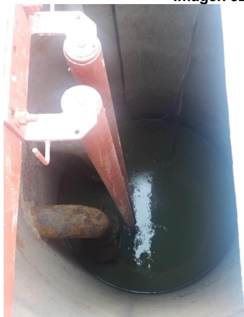
a) Sistema de bombeo.
