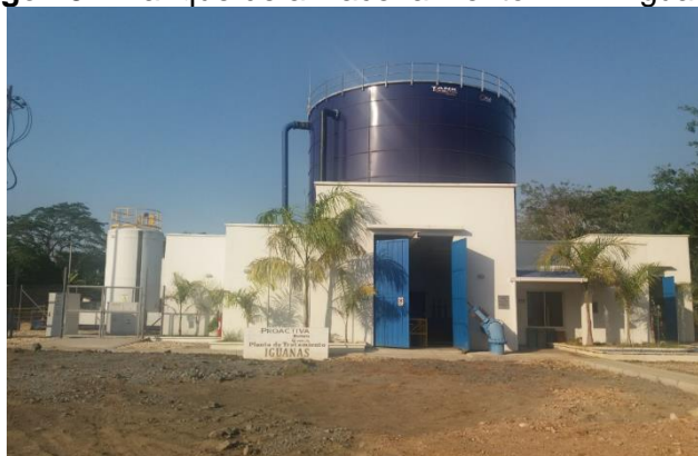
Imagen 37. Tanque de almacenamiento PTAP Iguanás II
