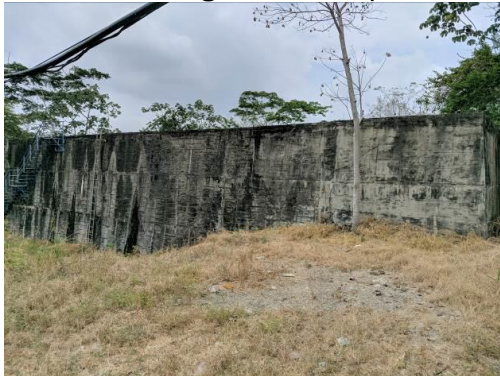
a) Tanque de 10.000 m 3 .
