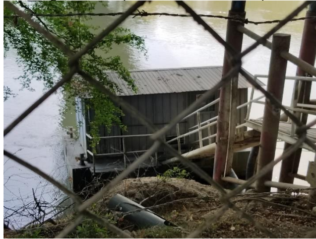
Imagen 19. Captación sistema Campanos
