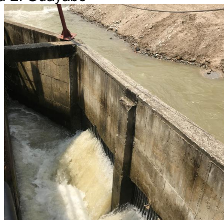
Rejillas de Captación
