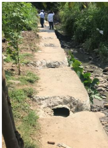
Red principal de alcantarillado.
