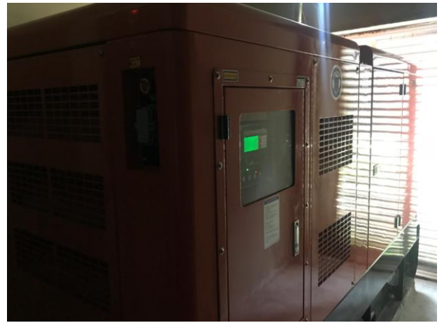
Planta de energía alterna
