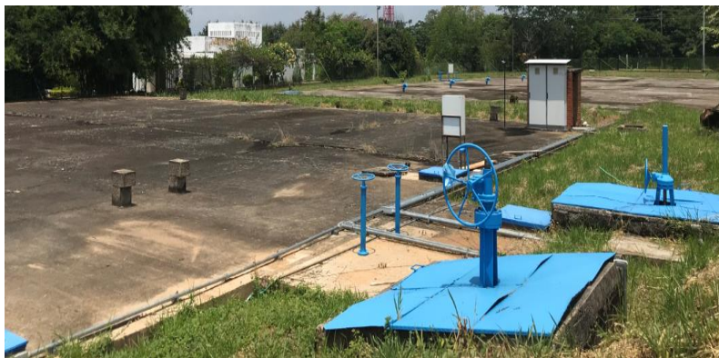
Tanques de almacenamiento PTAP El Recreo.
