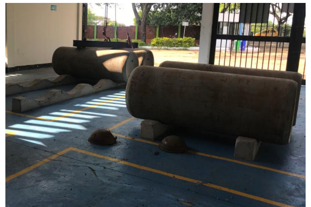
Caseta de cloro gaseoso.
