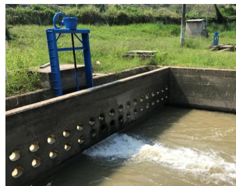
Compuerta de alimentación a los desarenadores
