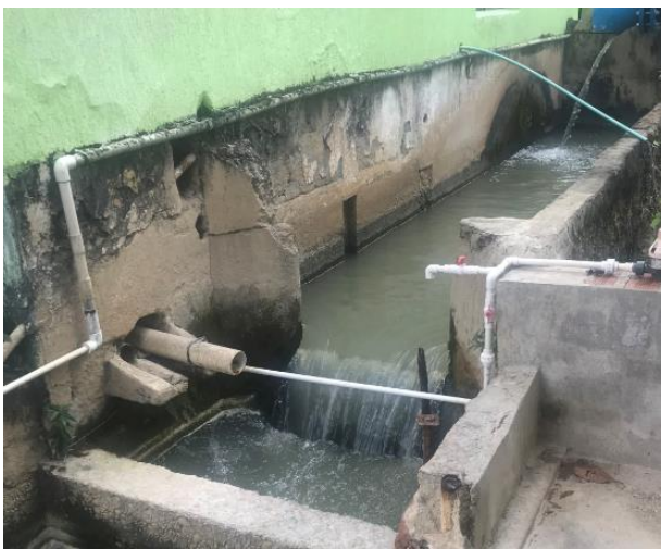
Canaleta parshall, dosificación del coagulante
