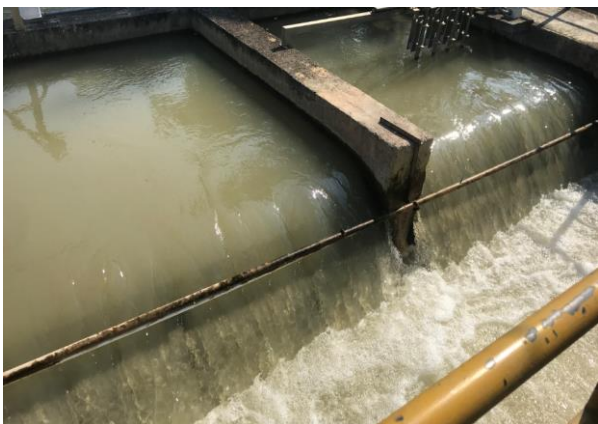
Adición del Coagulante en el resalto hidráulico
