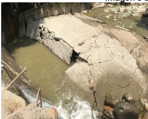
Dique en deterioro de la Bocatoma El Guayabo
