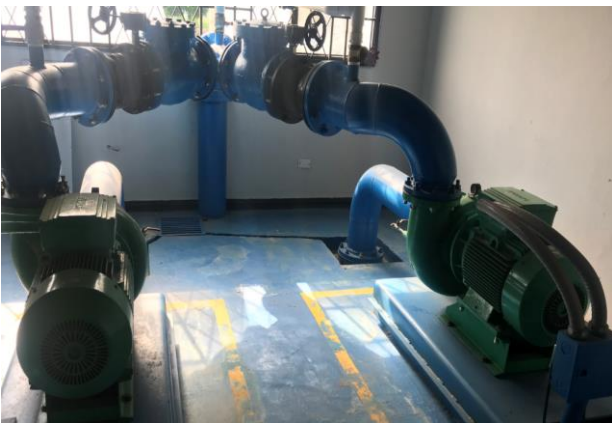
Bombas para lavado y mantenimiento del tren de tratamiento.
