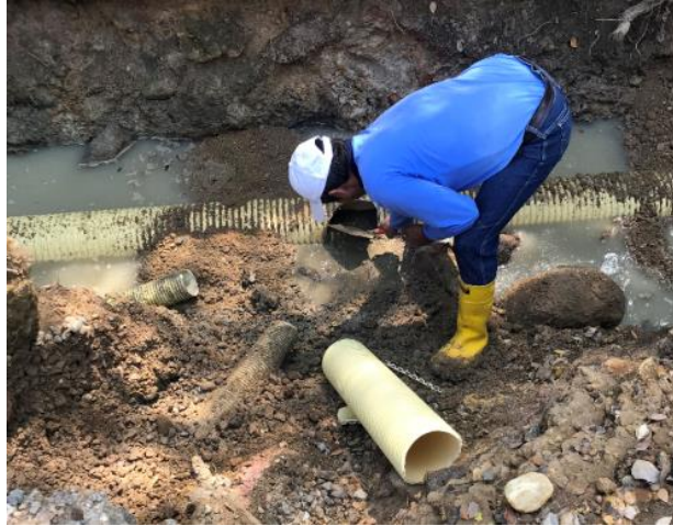
Tubería en PVC 10 pulgadas
