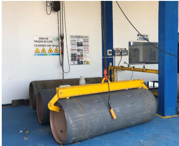
Caseta de cloro gaseoso Fuente: Registro fotográfico visita SSPD a EPN E.S.P.
