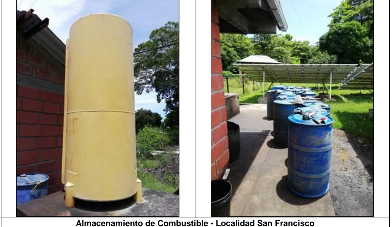
Ilustración 15 Almacenamiento de Combustible – San Francisco - EMSELCA
