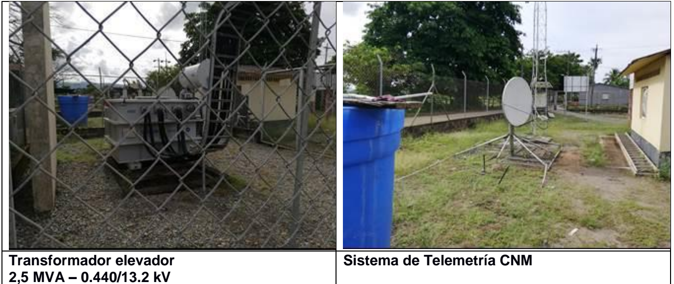
Ilustración 6 Transformador Elevador – Sistema de Telemetría CNM
