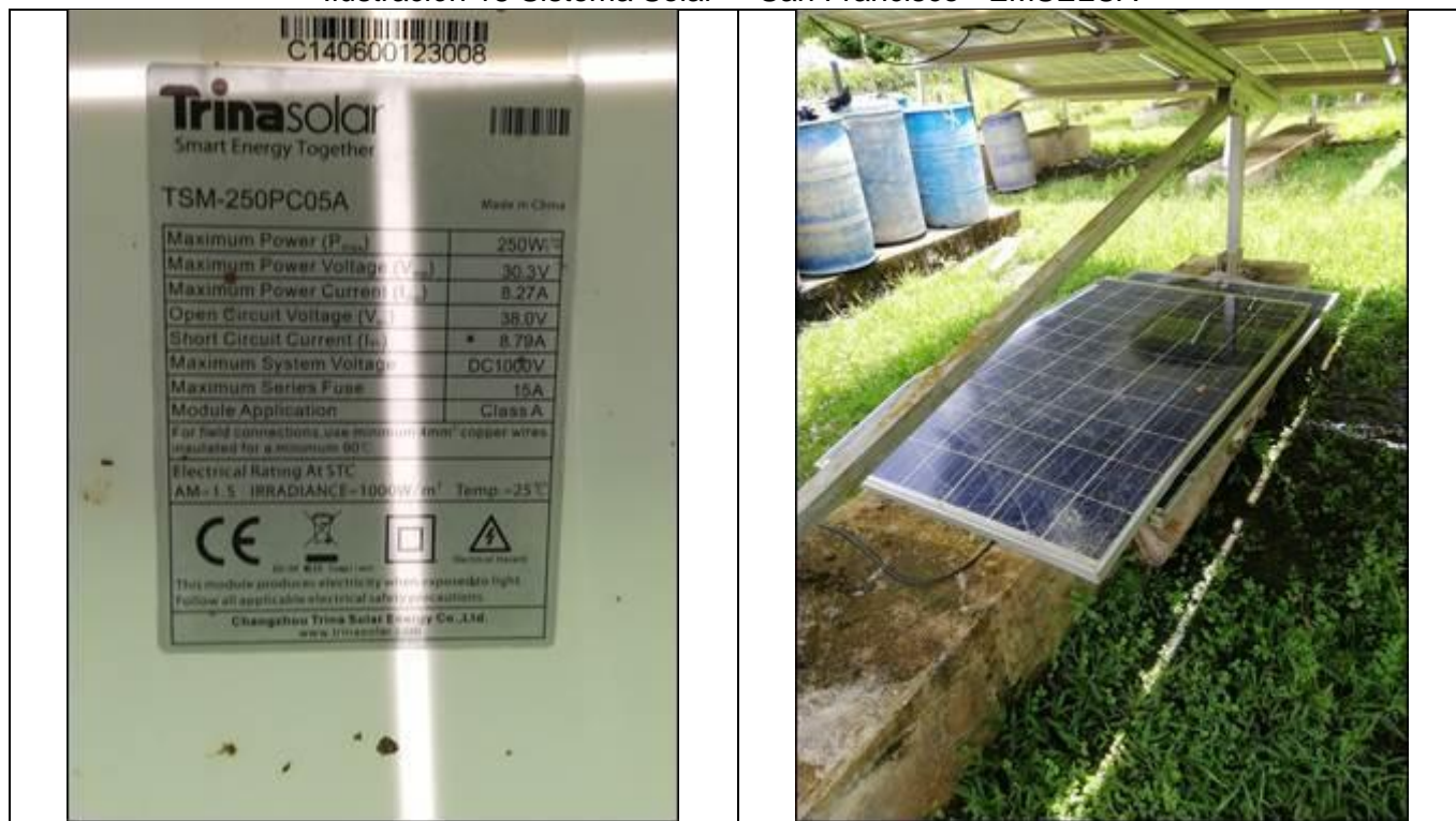
Datos de placa panel solar y paneles fuera de servicio - Localidad San Francisco
