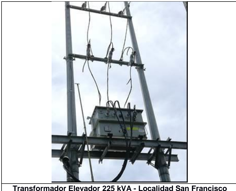
Ilustración 16 Transformador Elevador – San Francisco - EMSELCA
