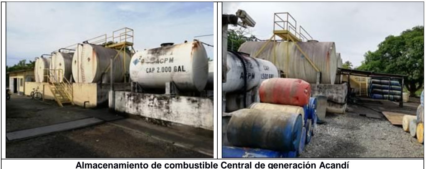
Ilustración 7 Almacenamiento de Combustible - Central de Generación Acandí
