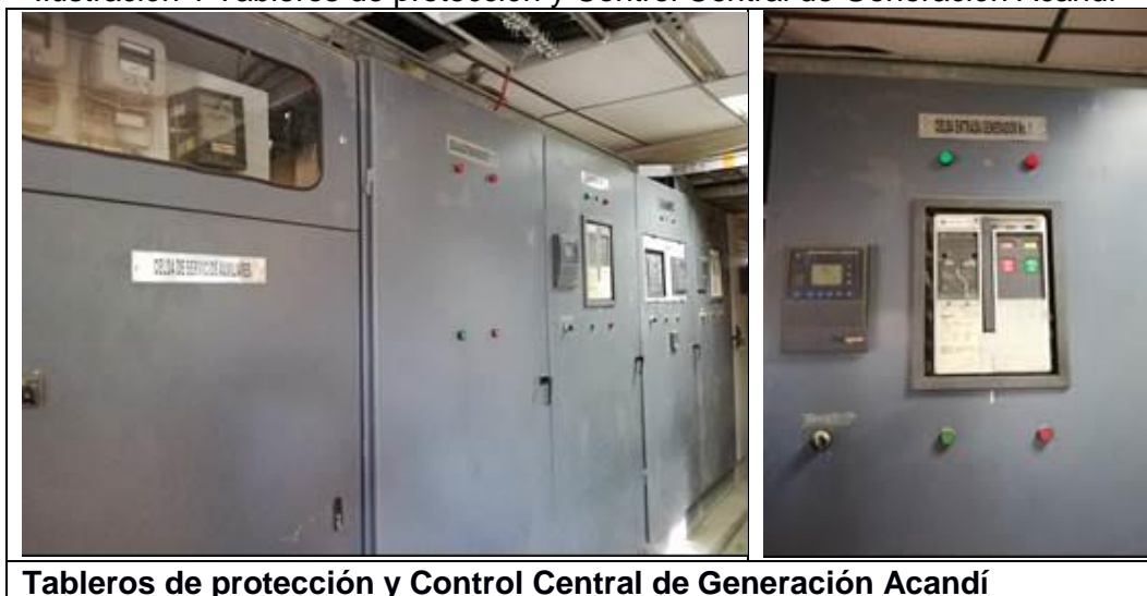
Ilustración 1 Tableros de protección y Control Central de Generación Acandí
