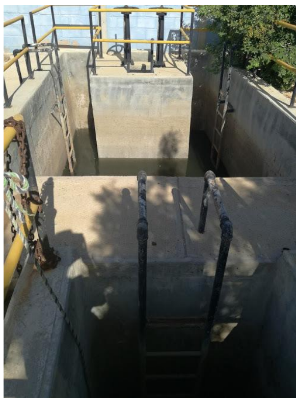
Imagen 26. Estación de bombeo de agua residual.
