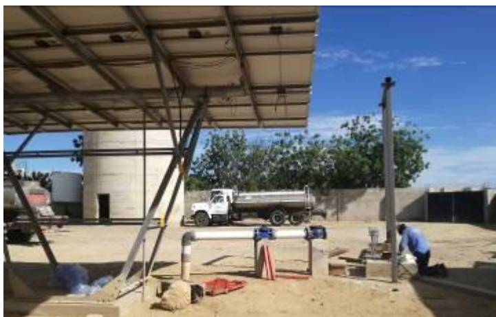
Imagen 8. Pozo 6 ubicado en las instalaciones administrativas.
