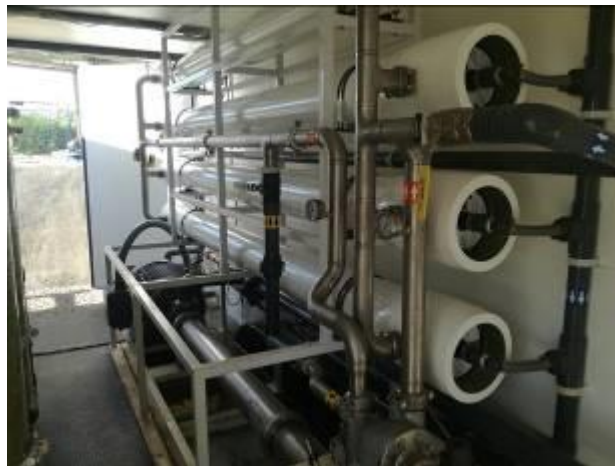
Imagen 19 Imagen 17. PTAP UNGRD ósmosis inversa.
