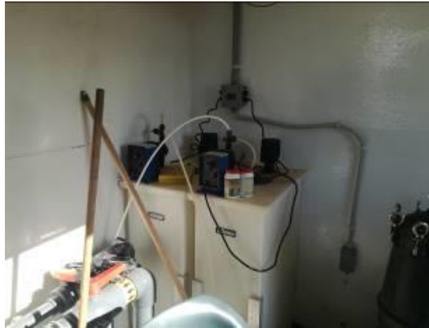
Imagen 21. PTAP UNGRD dosificadores de químicos.
