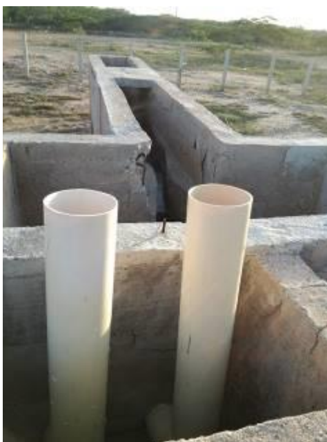
Imagen 29. Estructura de entrada Sistema de tratamiento de agua residual.
