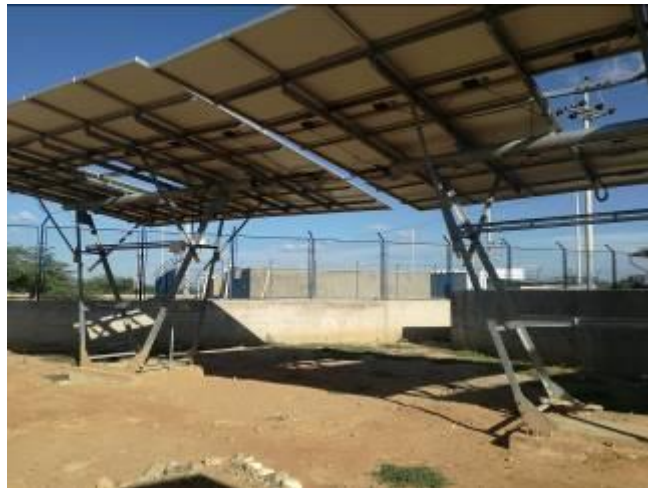
Imagen 6. Paneles solares fuente de energía Pozo 5.
