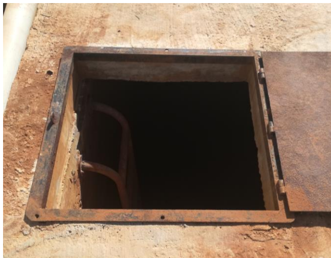
Imagen 15. Estado de los tanques de almacenamiento agua cruda.
