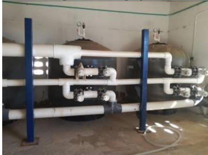
Imagen 14. PTAP antigua, filtros.
