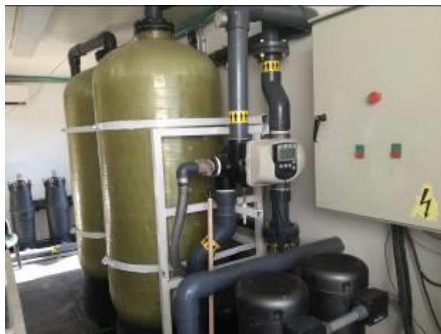
Imagen 20. PTAP UNGRD filtros.
