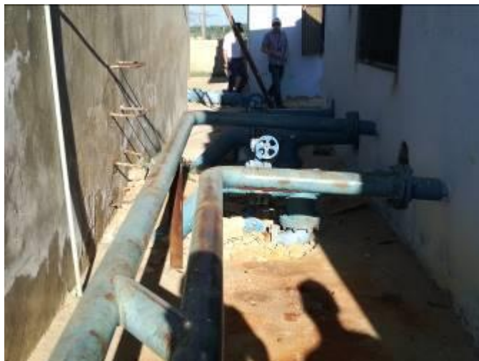
Imagen 10. Línea de conducción.
