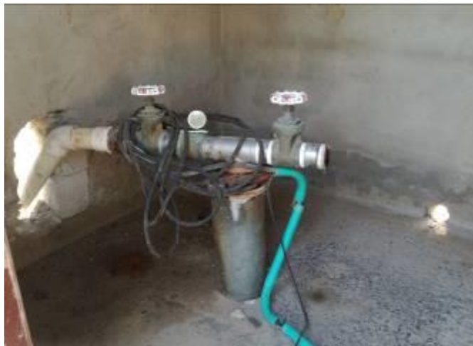
Imagen 7. Pozo de captación.
