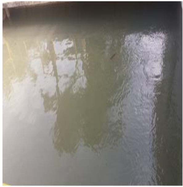
d) Tanques de filtración.
