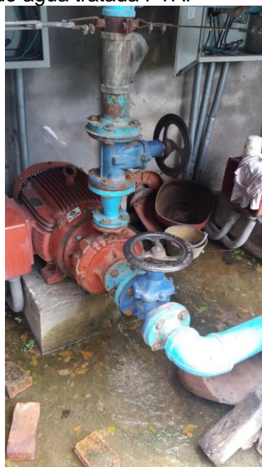
b) Estación de bombeo PTAP 2.
