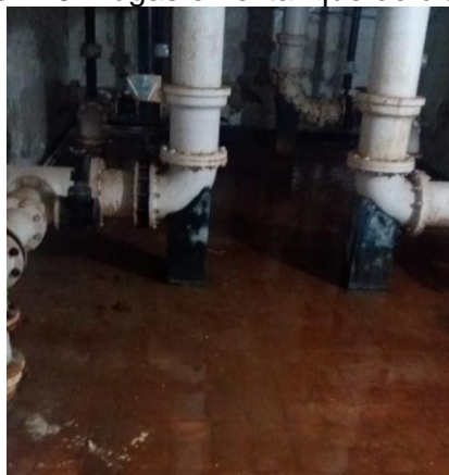
Imagen 19. Fugas en el tanque de cloración
