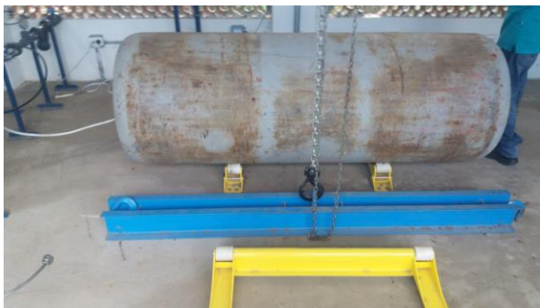
e) Tanque de cloro gaseoso.
