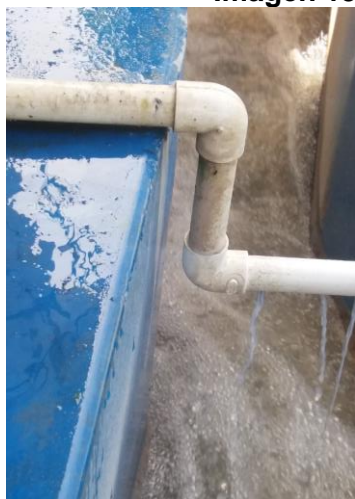
a) Canaleta Parshall.
