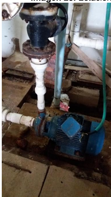
a) Estación de bombeo PTAP 1.
