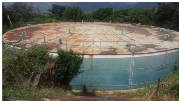
f) Tanque de almacenamiento.
