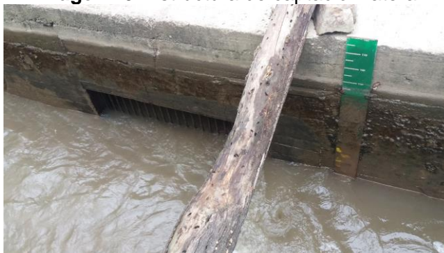
Imagen 10. Estructura de captación lateral
