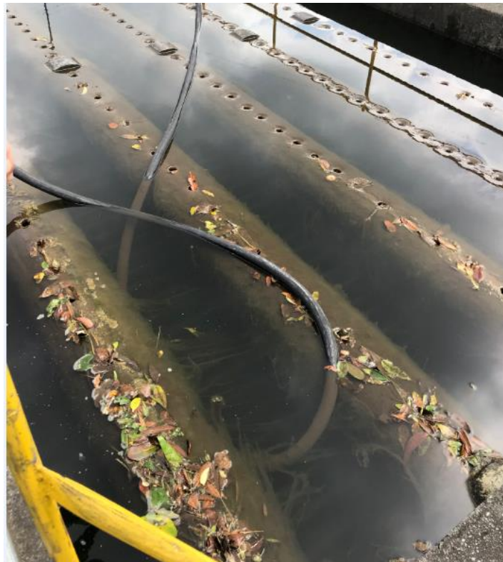
Módulo de Desarenador cubierto de materia vegetal, presunta falta de mantenimiento.
