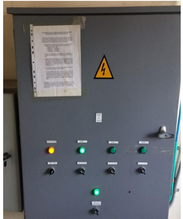
Automatización de las bombas
