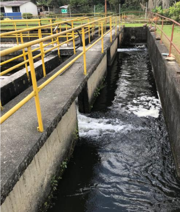
Canal de distribución a los desarenadores
