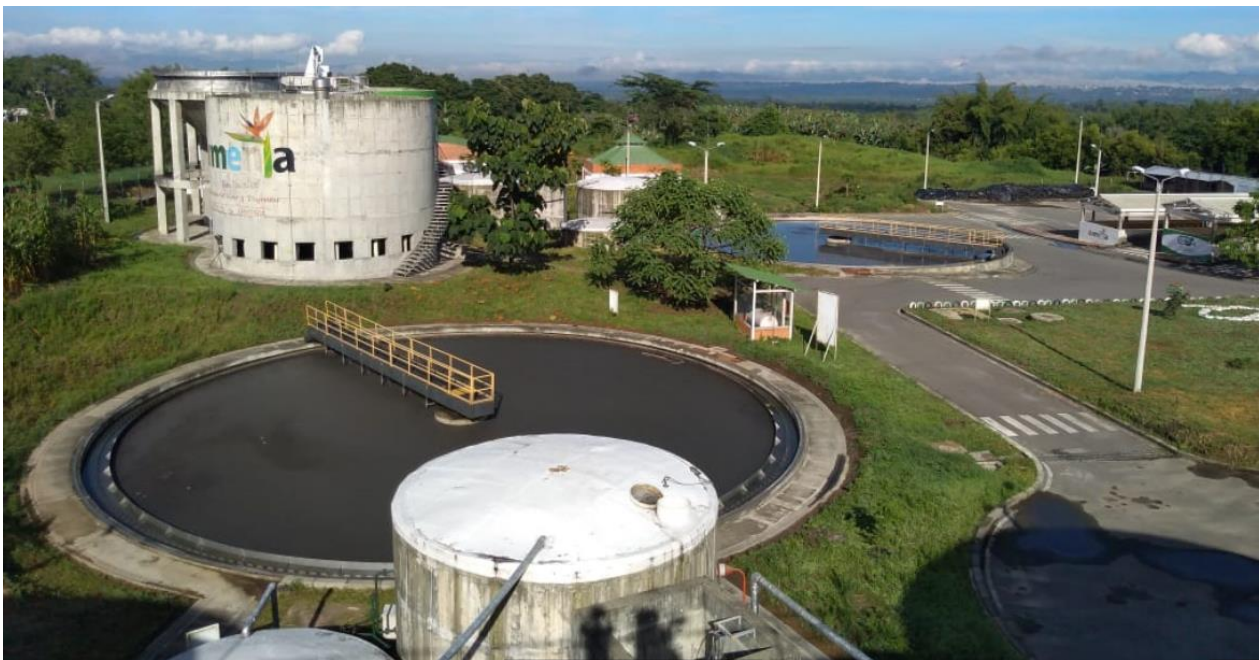
Vista General de la PTAR La Marina.
