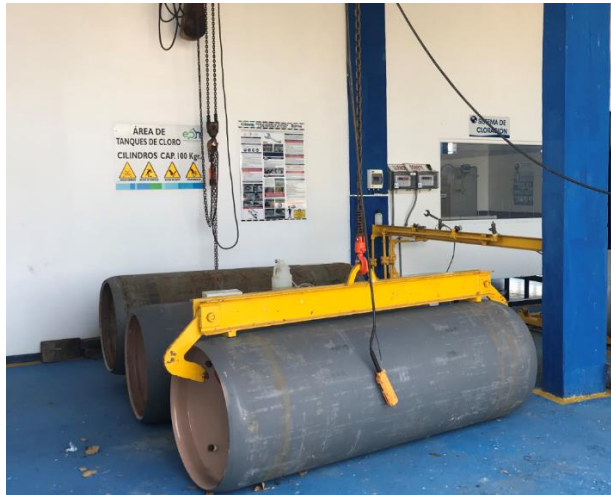
Caseta de cloro gaseoso
