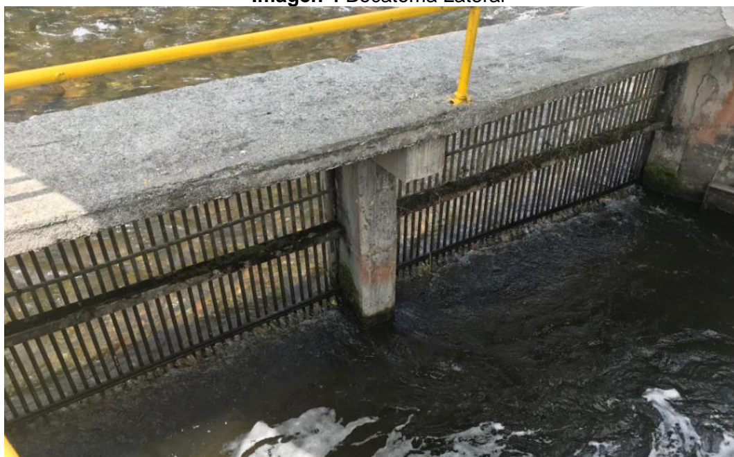
Rejillas de Captación.
